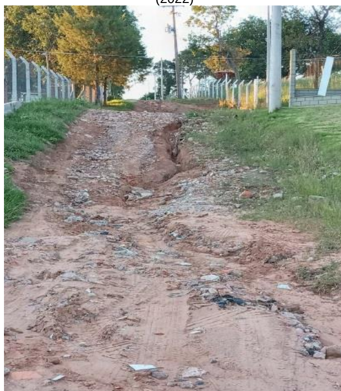
Figura 78: Estado da pavimentação nos empreendimentos “Sítios de Recreio Vila Bela I, II e III” (2022)
