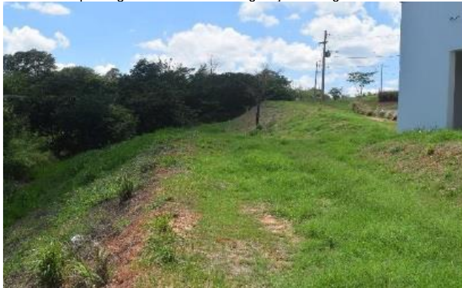
Figura 50: APP de corpo d'água – Ausência de vegetação na região do talude do salão de festas
