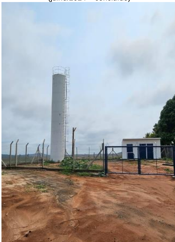
Figura 80: Poço e reservatório nos empreendimentos “Sítios de Recreio Vila Bela I, II e III” (julho/2024 – concluído)
