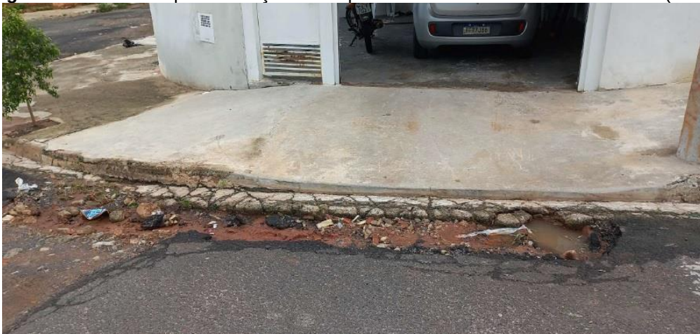
Figura 72: Estado da pavimentação no empreendimento "Altos do Nova Marília" (2022)
