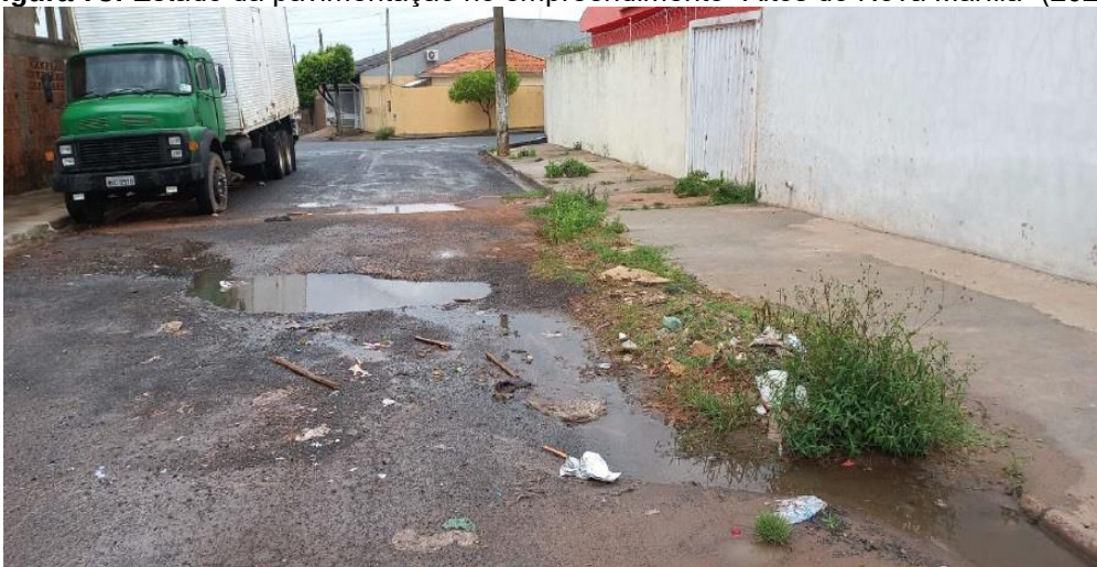
Figura 73: Estado da pavimentação no empreendimento "Altos do Nova Marília" (2022)
