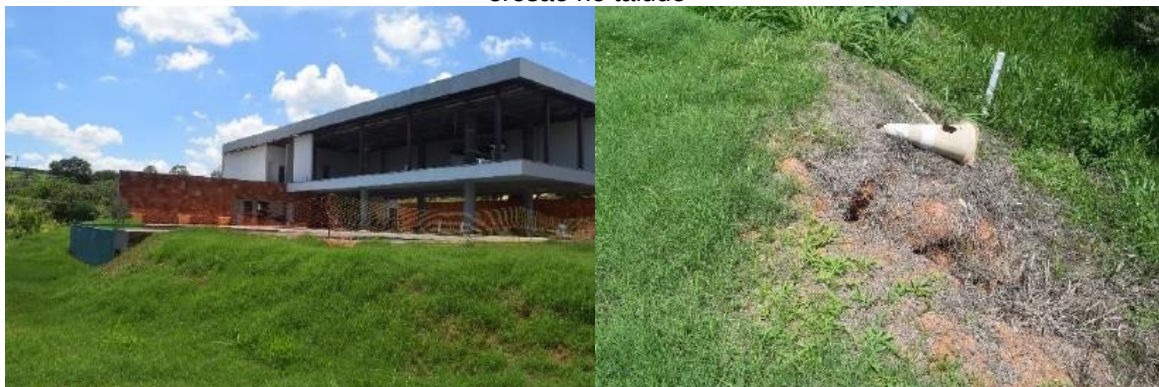
Figura 51: Vista do aterro com o salão de festas do empreendimento, com obras em andamento e erosão no talude
