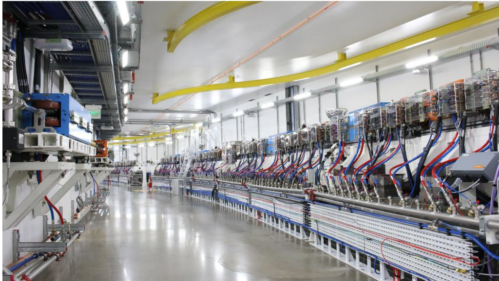
Figura 4 - Vista do interior da blindagem do acelerador de partículas
