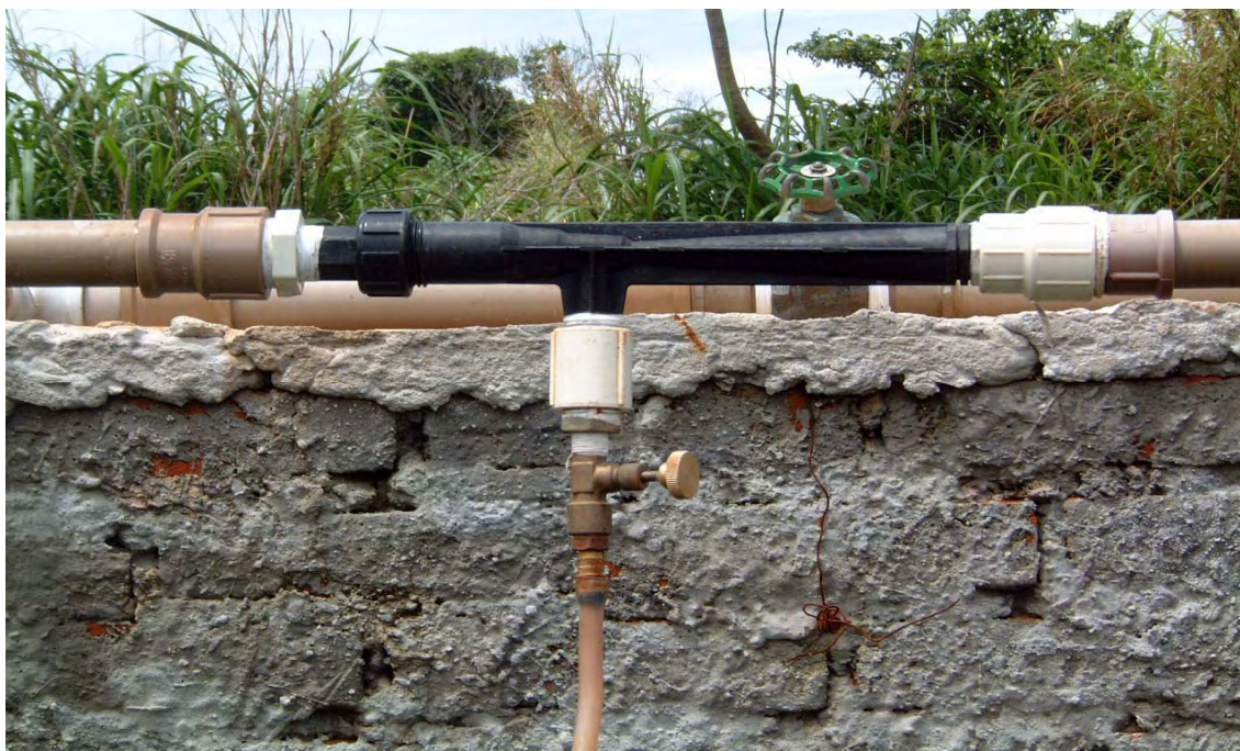
Figura 2 Vista do injetor venturi utilizado no experimento
