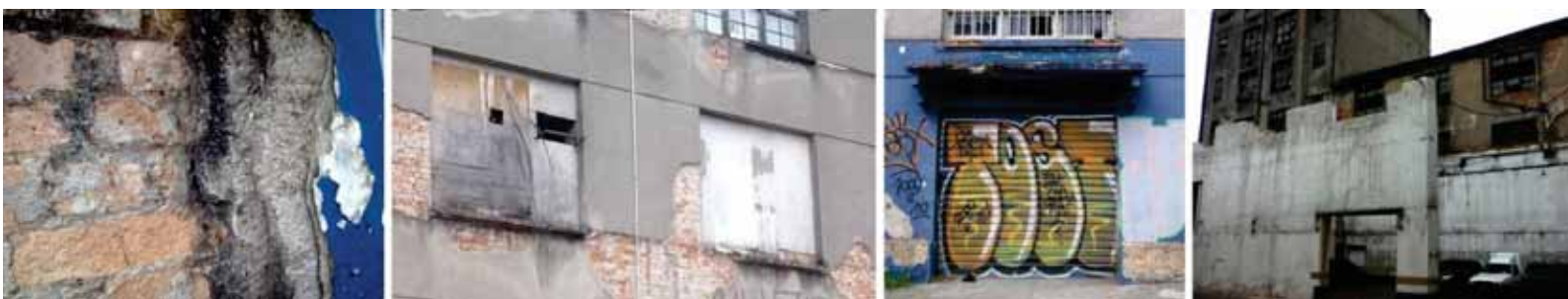
Figura 7. Estado atual da edificação – Reboco, Esquadrias e vãos, Pichações e Demolição
