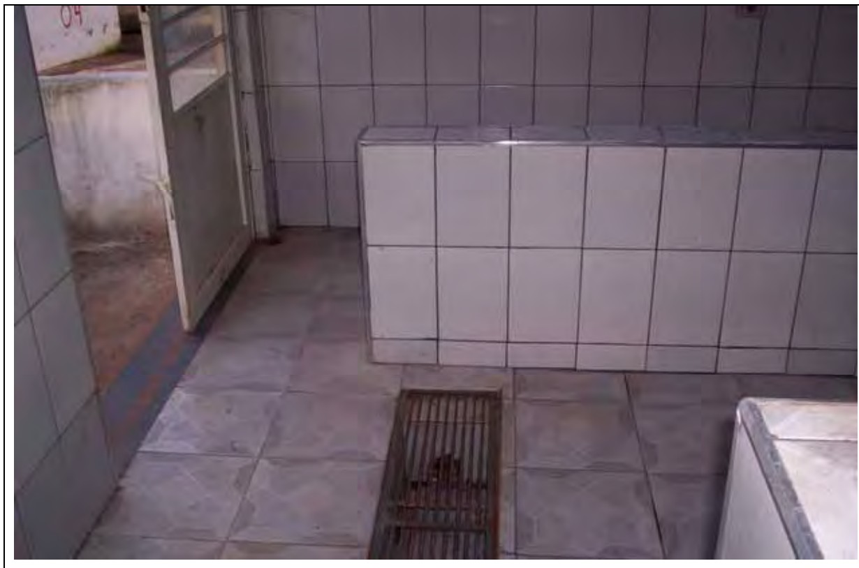
Figura 22 Abatedouro – Escoamento de resíduos Fonte: Etec AMC
