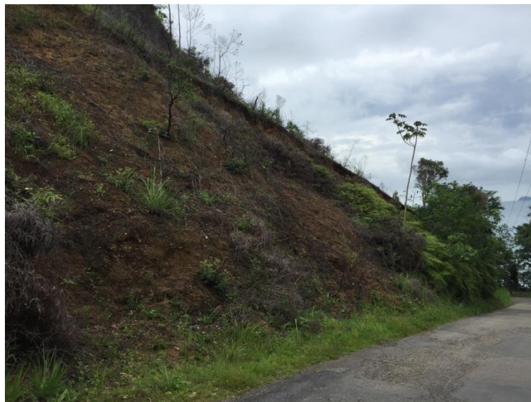
Figura 21 - Talude escorregado do 3º segmento.
