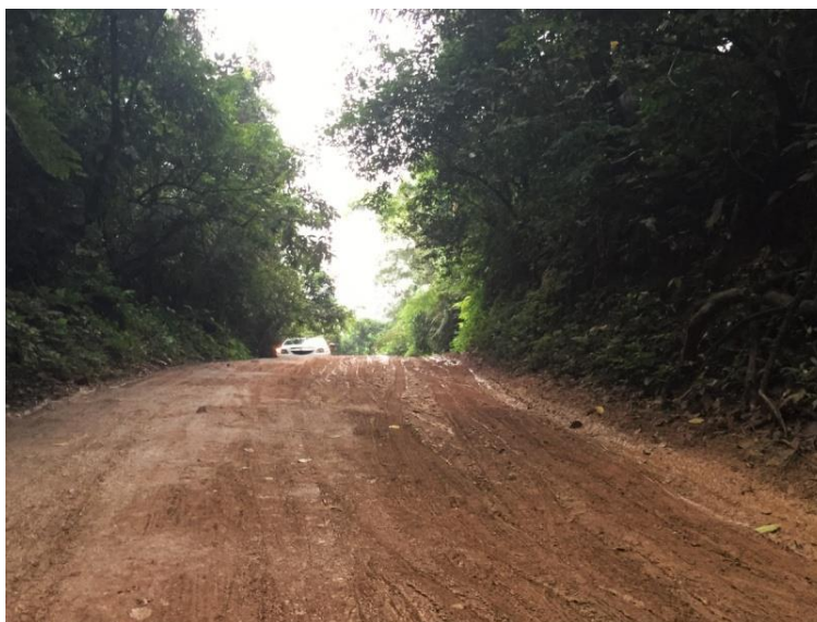
Figura 11 - Trecho não pavimentado em época chuvosa.
