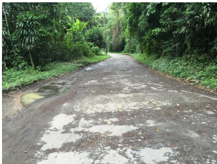
Figura 20 - Foto evidenciando as péssimas condições do asfalto.
