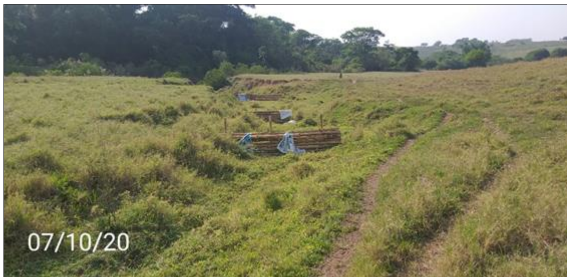
Figura 9 - Barramentos com as sacarias danificadas
