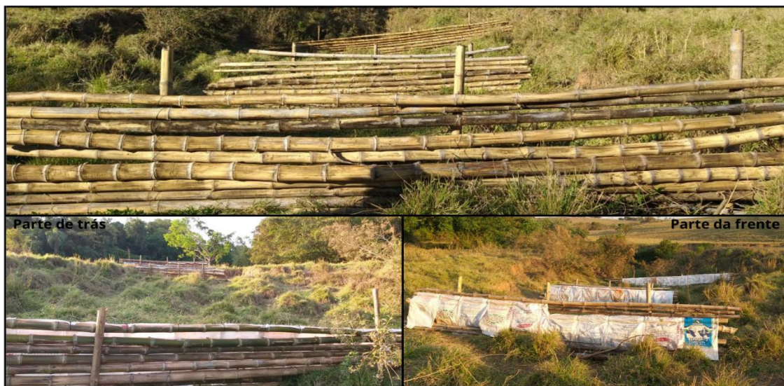
Figura 5 - Visão geral dos barramentos (Ravina 1)
