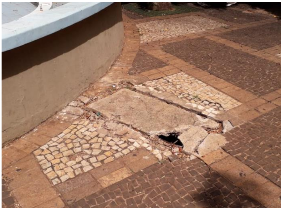
Figura 59 – O calçamento danificado é um risco eminente para os usuários
