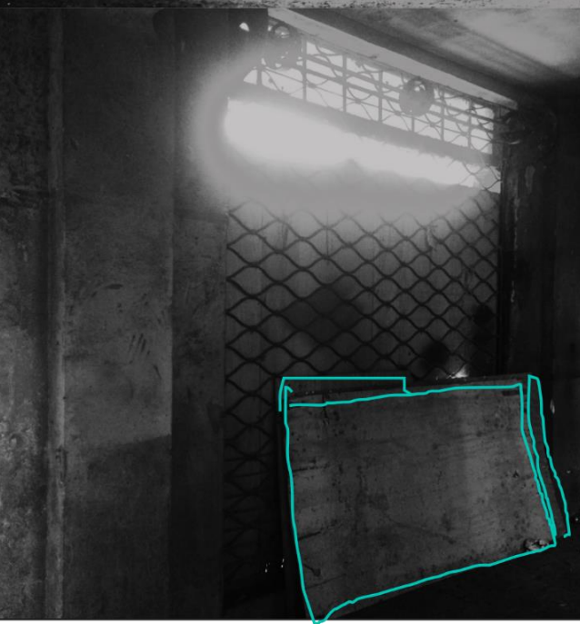
FIG 36: Detalhes Internos do Cinema atualmente. No sentido horário: O saguão Principal, hoje nivelado e vazio. Todo telhado foi reformado, porém mantendo o desenho original. A porta principal, apesar de bastante marcada pelo tempo ainda é um elemento caracterizador de grande relevância ... Fonte: Autora, 2016
