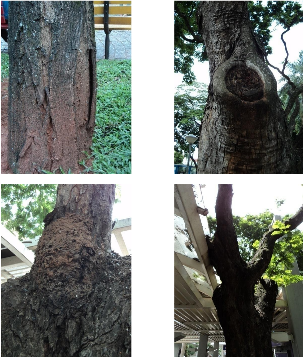
Figura 17. Árvores com sintomas de ataque de pragas e doenças na praça Rui Barbosa, São José do Rio Preto, SP, 2015.
