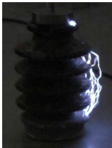
Figura 3 – Falha em isolador.
