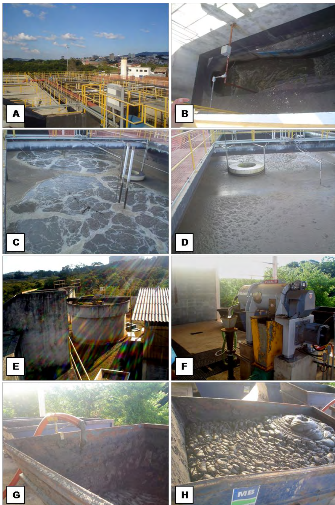
Figura 4 - ETE Estoril, Atibaia-SP. A: vista geral da estação; B: chegada do esgoto; C: fase de aerção; D: fase de flotação/decantação; E: decantador de lodo; F: centrífuga desaguadora de lodo; G: chegada do lodo desaguado; H: lodo de esgoto desaguado.
