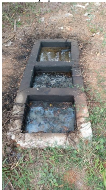
Figura 6 – Caixa separadora de água e óleo conectada ao sistema de limpeza de peças e equipamentos
