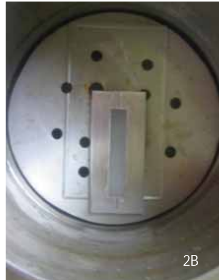
Figura 2B - Interior da Painel Elétrica Semi Automática
