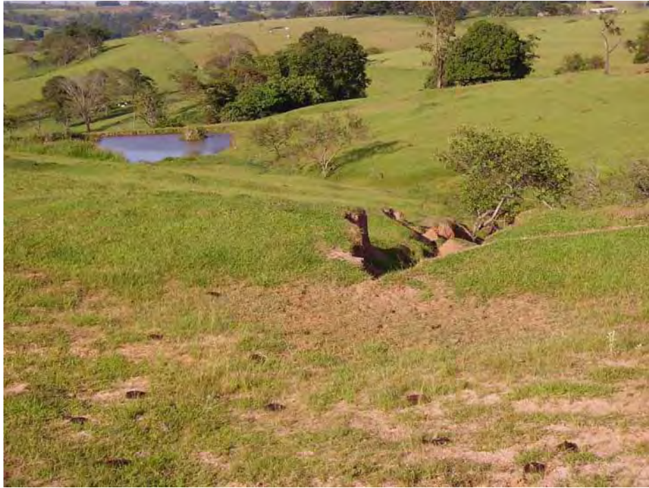
Fotografia 5 – Terraço danificado e represa com pouca proteção vegetal (médio curso, 2005)
