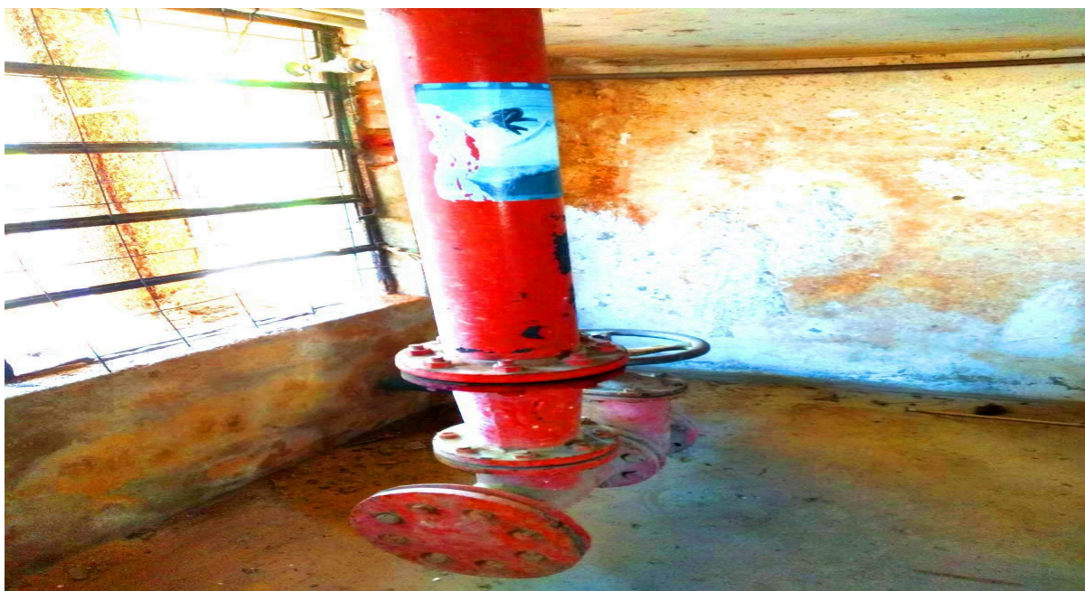
Figura 33 - Registro de 150 milímetros.
