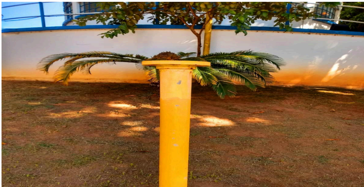
Figura 32 - Tubulação de 100 milímetros.
