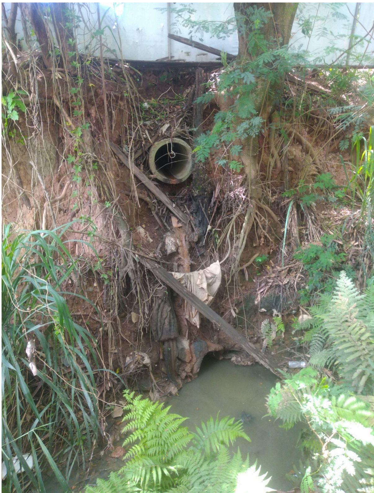
Figura 2 - Ponto de descarte de água residuária municipal não tratada do lavador da Diretoria de Serviços Municipais - DSM e do SAAE Aparecida/SP
