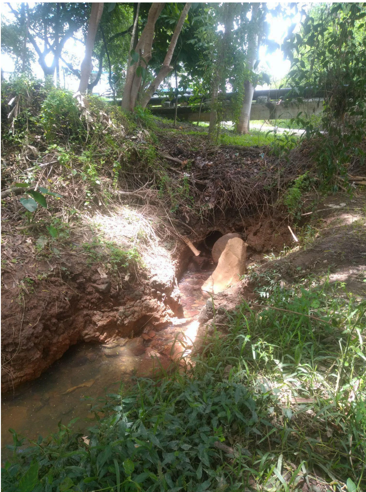
Figura 3 - Ponto de descarte de água residuária municipal não tratada da ETA do SAAE Aparecida/SP.
