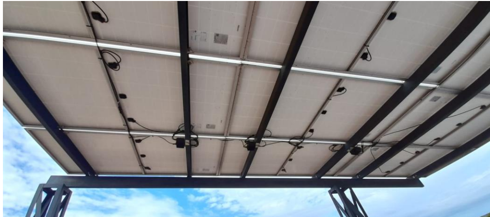
Figura 44 – Conexão das placas aos Otimizadores de potência.
