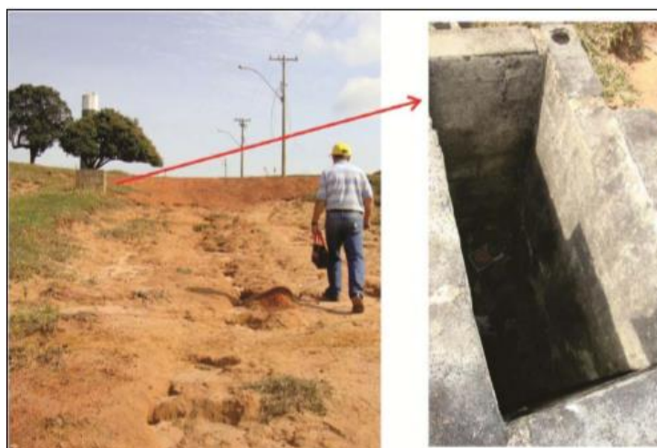
Figura 43 - Caixa de passagem próxima a rua.
