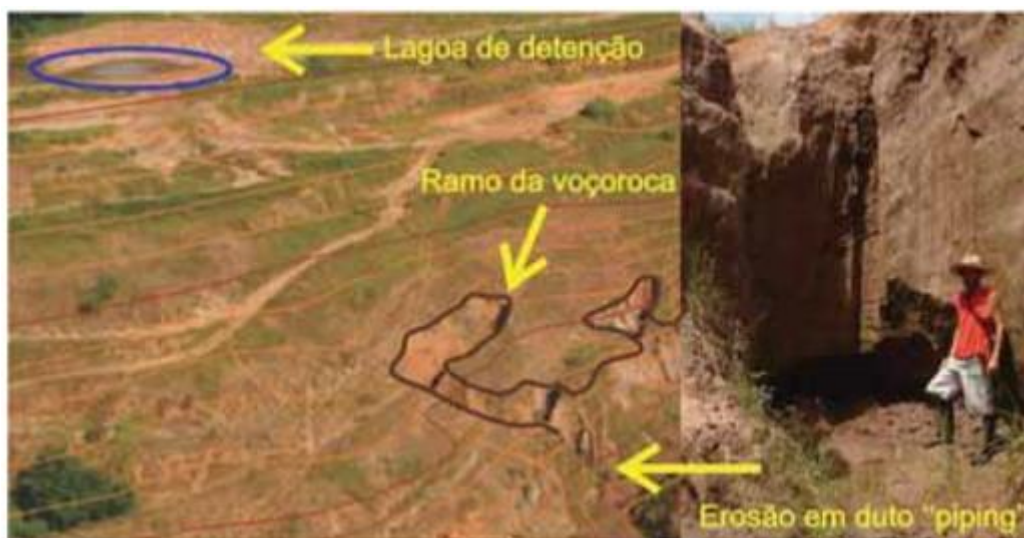
Figura 64 - Bacia de contenção e ocorrência de piping na mesma topografia.
