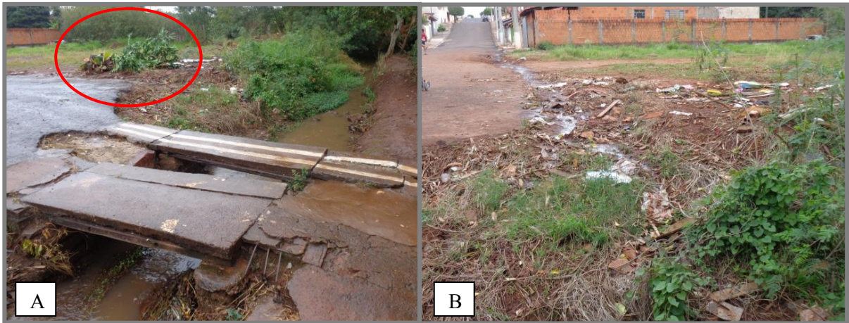
Figura 21 - A) Depósito de entulho e galhos; B) Lixo no local destinado ao despejo de entulho. Fotografia da autora, 2015.
