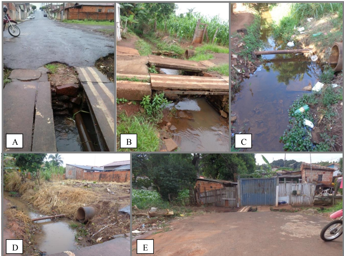
Figura 20 - A) Rua Cristiano Rodrigues da Silva; B) Ponte de concreto; C) Resíduos no córrego; D) Capina química realizada na margem do córrego; E) Limite da rua com a ponte que liga ao quintal das casas da outra margem.
