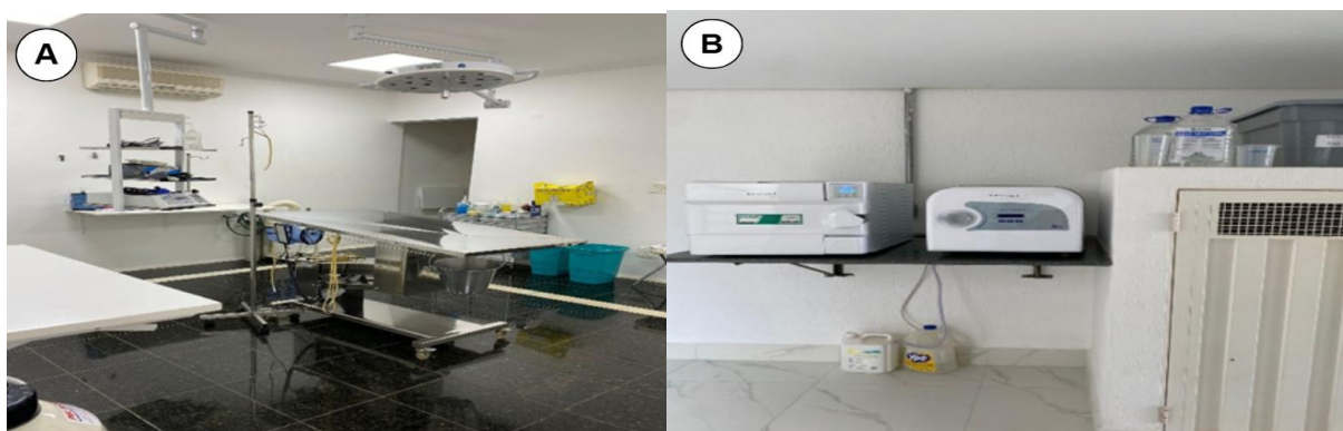
Figura 11. Estrutura do centro cirúrgico da clínica OncoHealth. A. Centro cirúrgico. B. Sala de esterilização com autoclaves.
