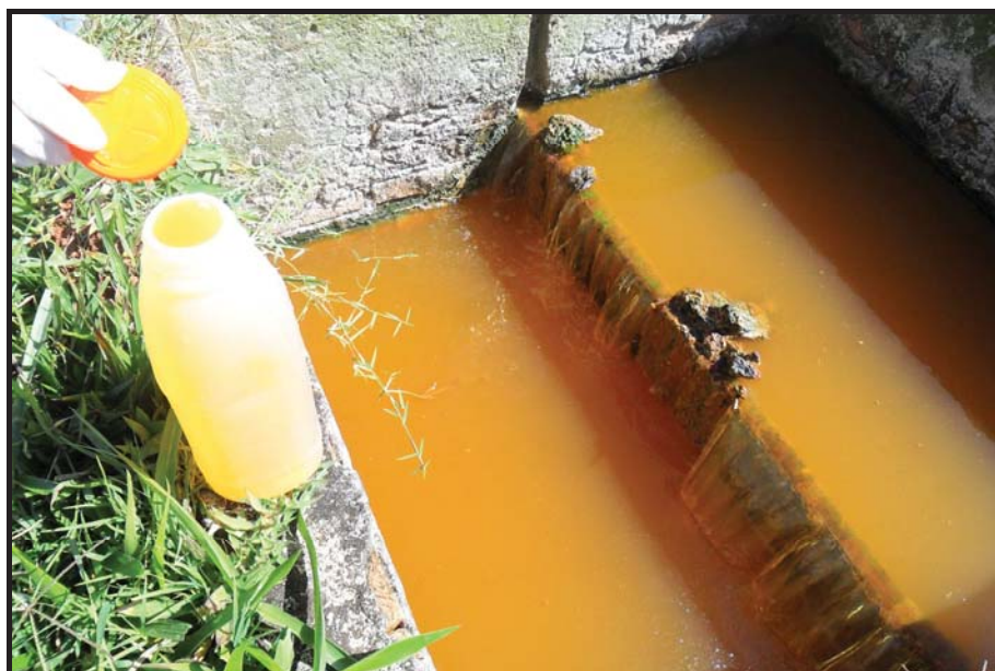
Figura 05: Saída da primeira Lagoa de Estabilização, com a estrutura do vertedouro, evidenciando a coloração das águas residuárias. Foto: Junho /2011.
