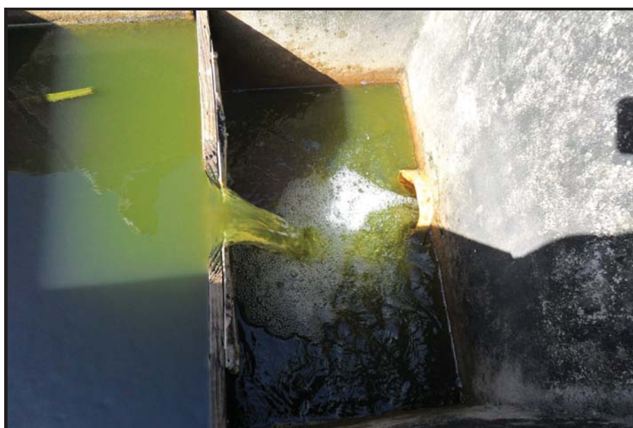
Figura 13: Saída do sistema de tratamento. Foto: Junho /2011.
