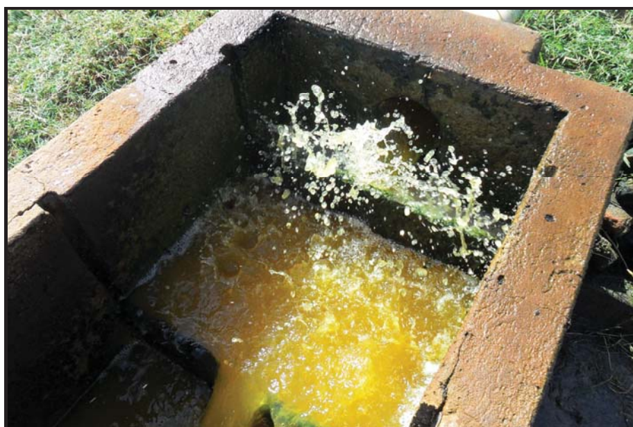
Figura 09: Detalhe da saída da terceira Lagoa de Estabilização. Foto: Junho /2011.
