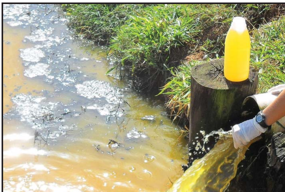
Figura 07: Saída da segunda Lagoa de Estabilização. Foto: Junho /2011.
