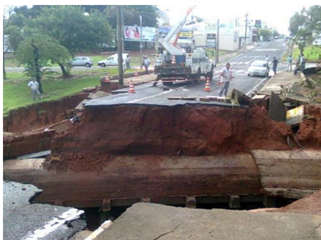
Figura 22 - Cratera que se formou em uma travessa da Avenida José Munia
