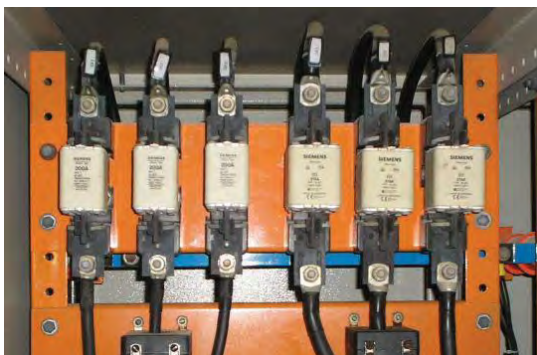
Figura 20 – Fotografia da caixa de fusíveis (MHF, 2009)
