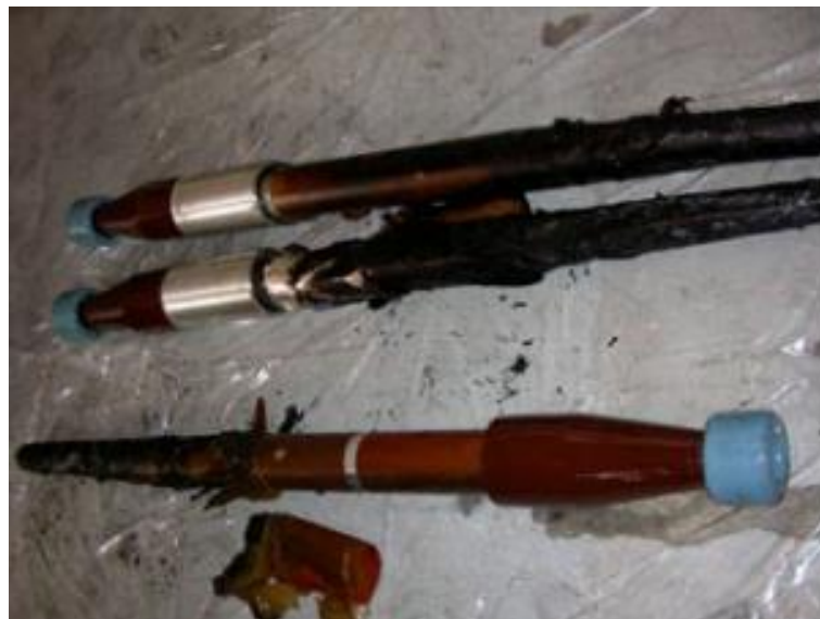
Figura 14. Danos Gerados por Curto-Circuito na Bucha
