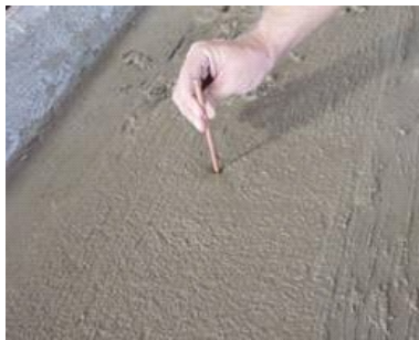
Figura 5.1 - Tubo de cobre no concreto
