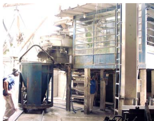
Figura 4.1 - Betoneira e cabine de controle
