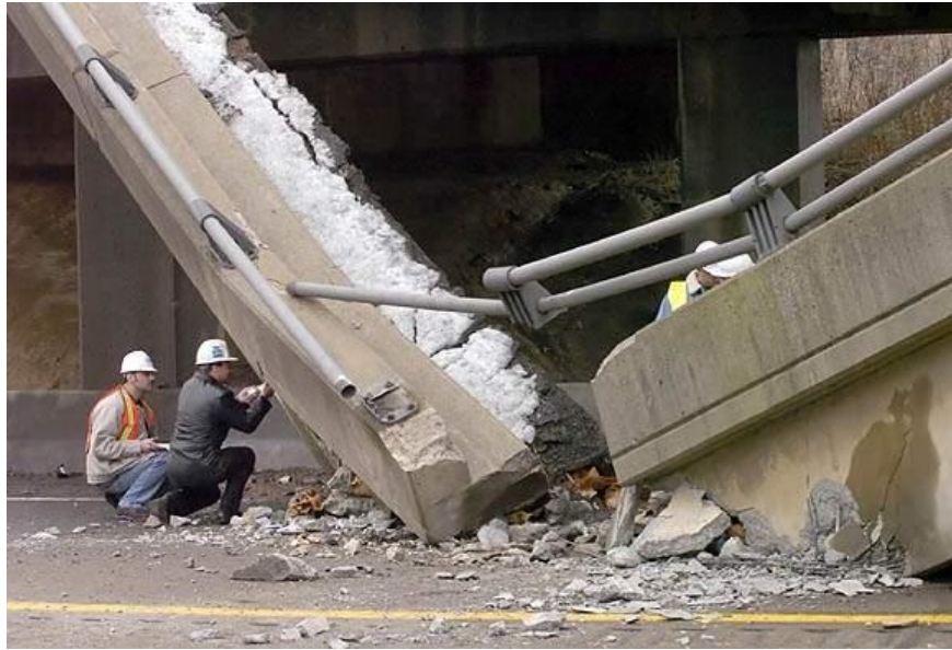
Figura 24 – Análise de falha em estrutura.
