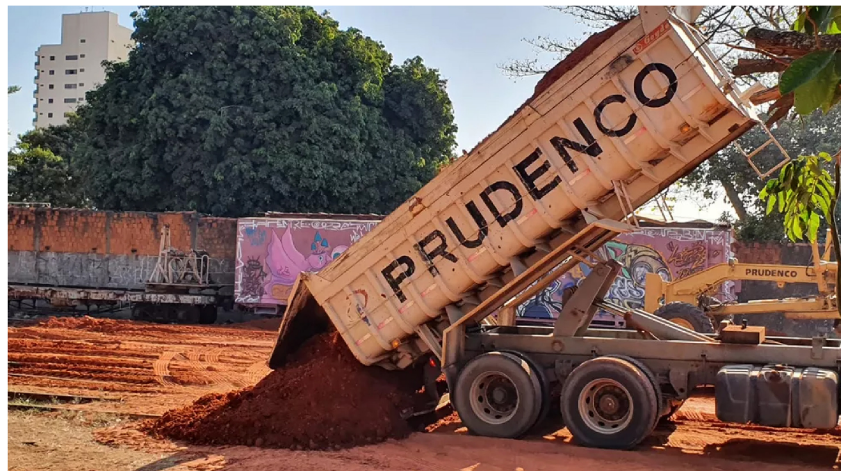
Figura 10: Momento no qual ocorria o aterramento dos trilhos. Fonte: Matéria do G1, 2022.
