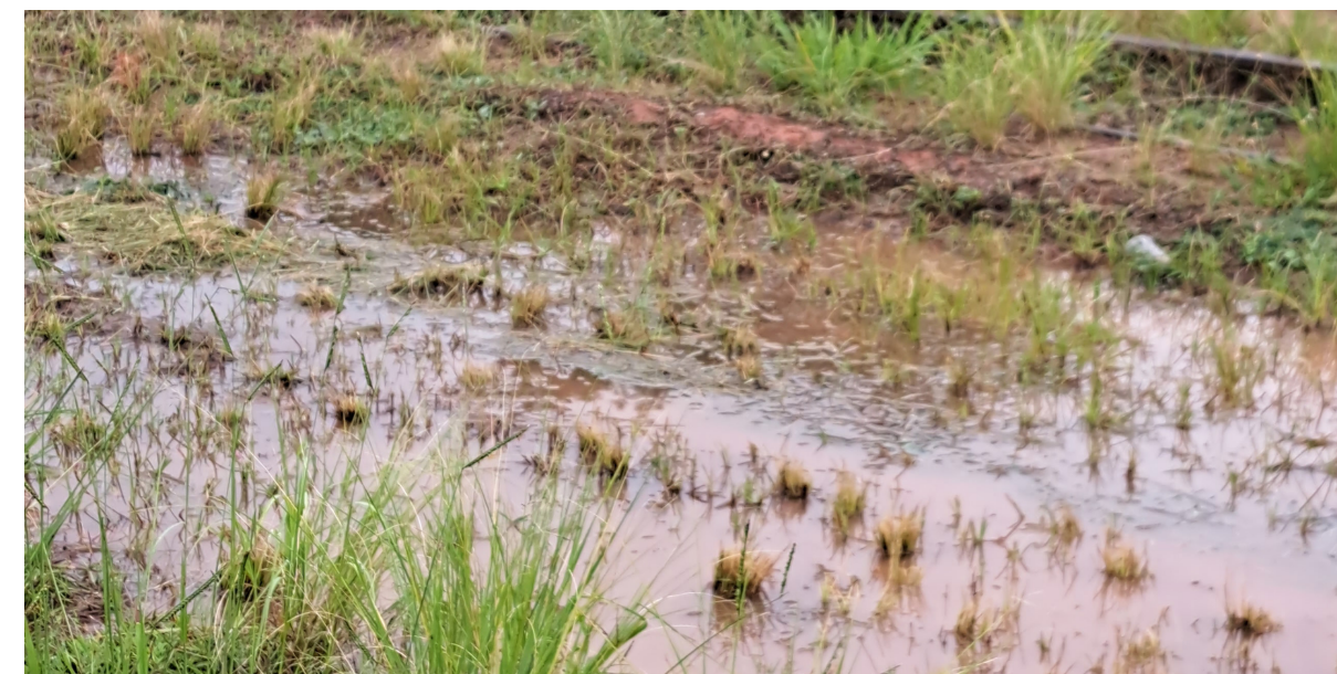
Figura 39: Poças de água acumuladas sobre os trilhos. Fonte: autora, 2023.
