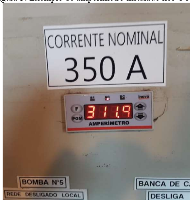
Figura 5: Exemplo de amperímetro instalado nos CCMs
