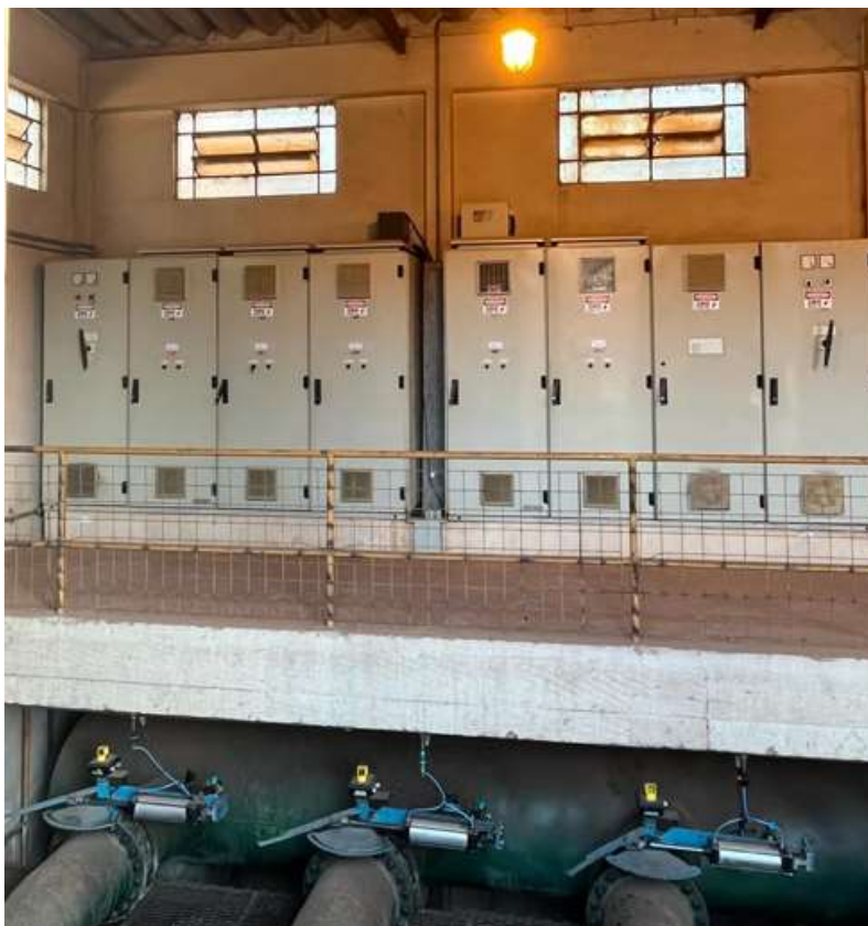
Figura 4: Local de instalação do CCM das bombas
