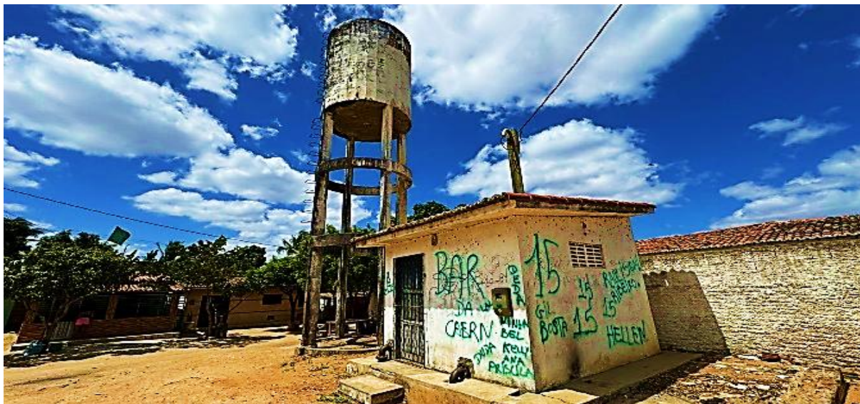
Figura 26 – Unidade de Captação de água da comunidade
