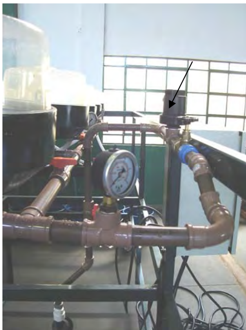
Figura 3. Localização da ventosa do início do sistema. (antes do manômetro e do registro de pressão)
