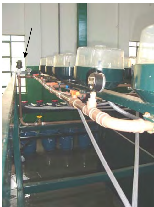
Figura 4. Localização da ventosa do fim do sistema. (depois do manômetro e antes do registro de gaveta)
