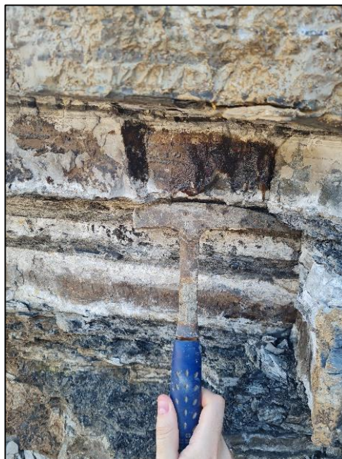
Figura 19- Presença de hidrocarbonetos em juntas.
