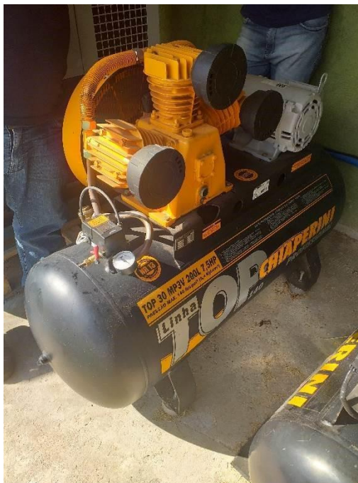
Figura 15 - Compressor de ar comprimido
