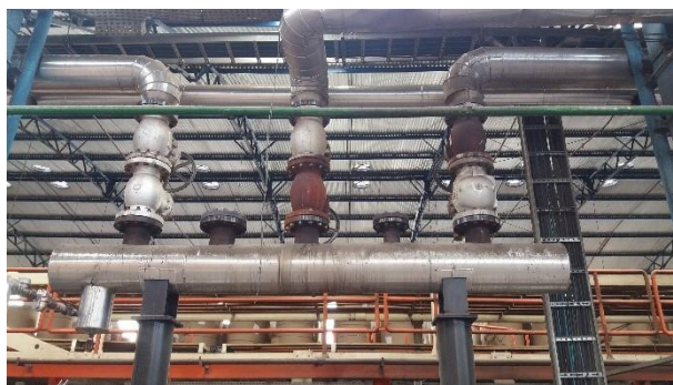
Figura 16 - Local para instalação da válvula de segurança
