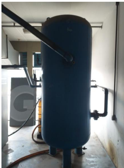
Figura 14 - Pulmão de ar comprimido
