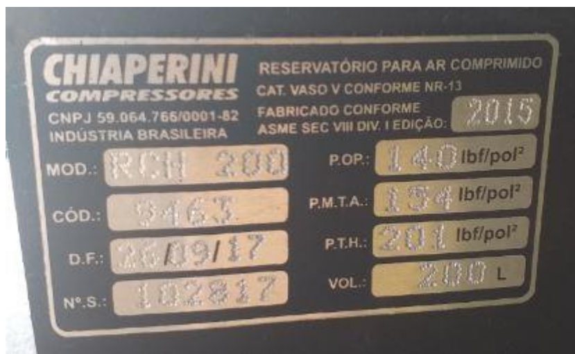
Figura 21 - Placa de identificação do compressor
