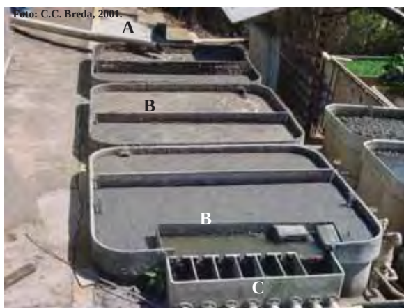
Figura 4: Vista geral das caixas de decantação. (A) entrada de efluente; (B) parte superior das grades e da peneira; (C) divisor de fluxo.
