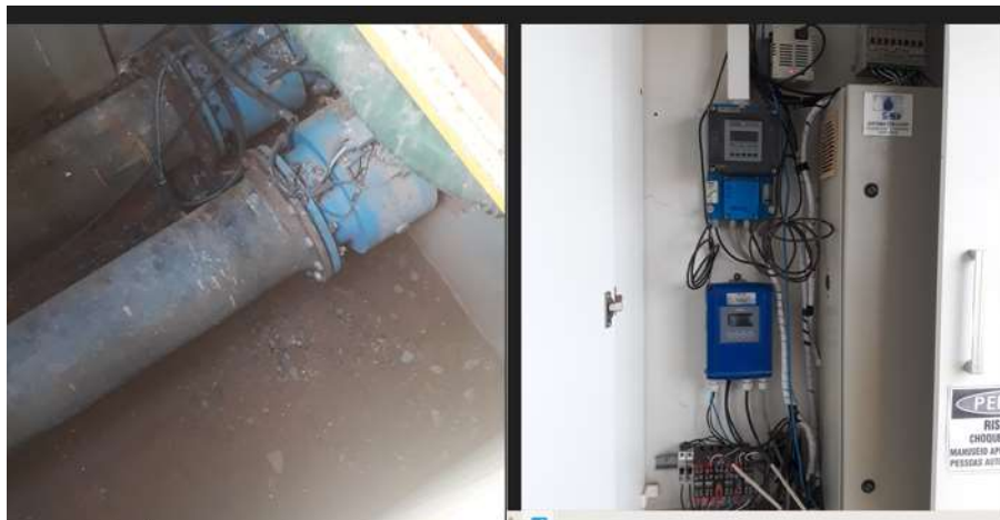
Figura 34 - Macromedidor do tipo eletromagnético instalado nas dependências da Estação de Tratamento de Água, na entrada de água bruta
