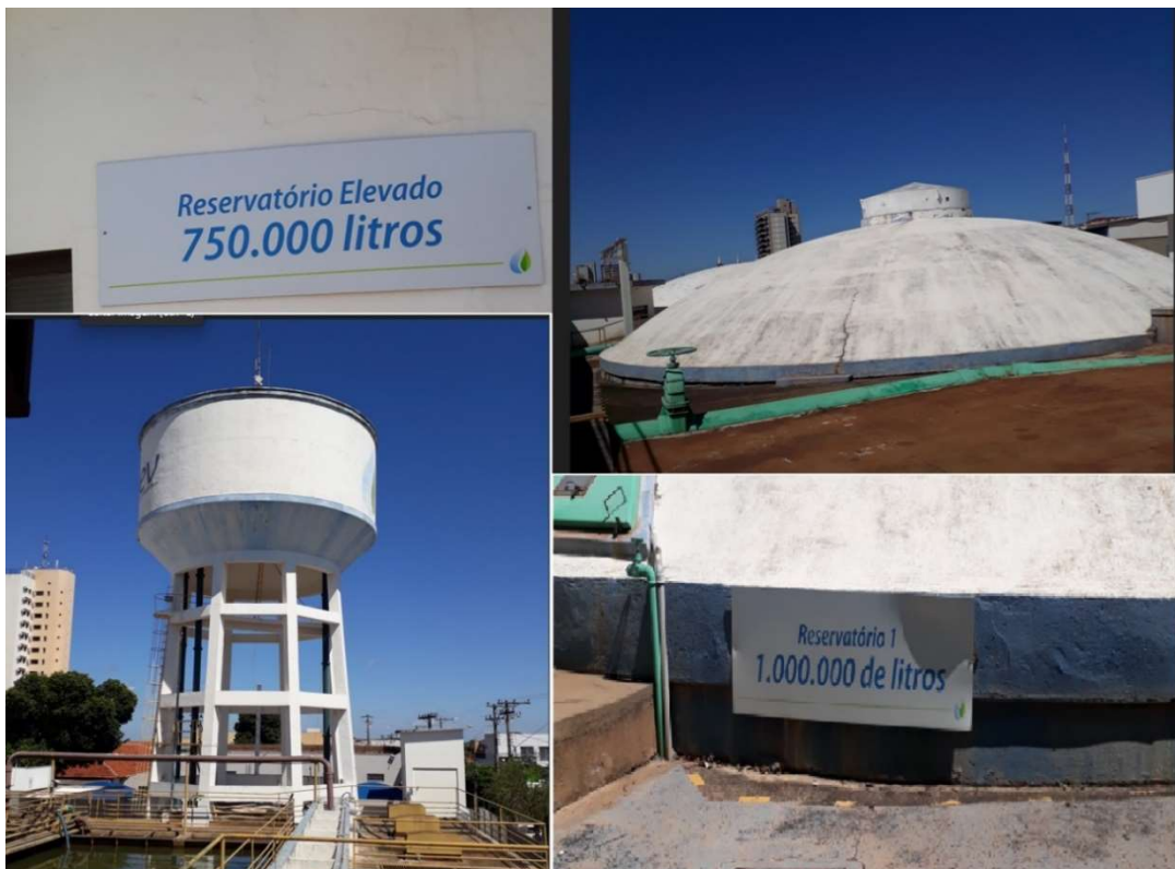
Figura 33 - Sistema de Abastecimento da Região Central de Votuporanga, composto por dois reservatórios enterrados (capacidade 1000 m³), e um elevado (capacidade 750 m³), além da Estação de Tratamento de Água superficial
