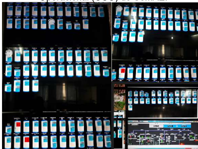
Figura 27 - Sistema de monitoramento por telemetria do Centro de Controle Operacional (CCO) do SeMAE.
