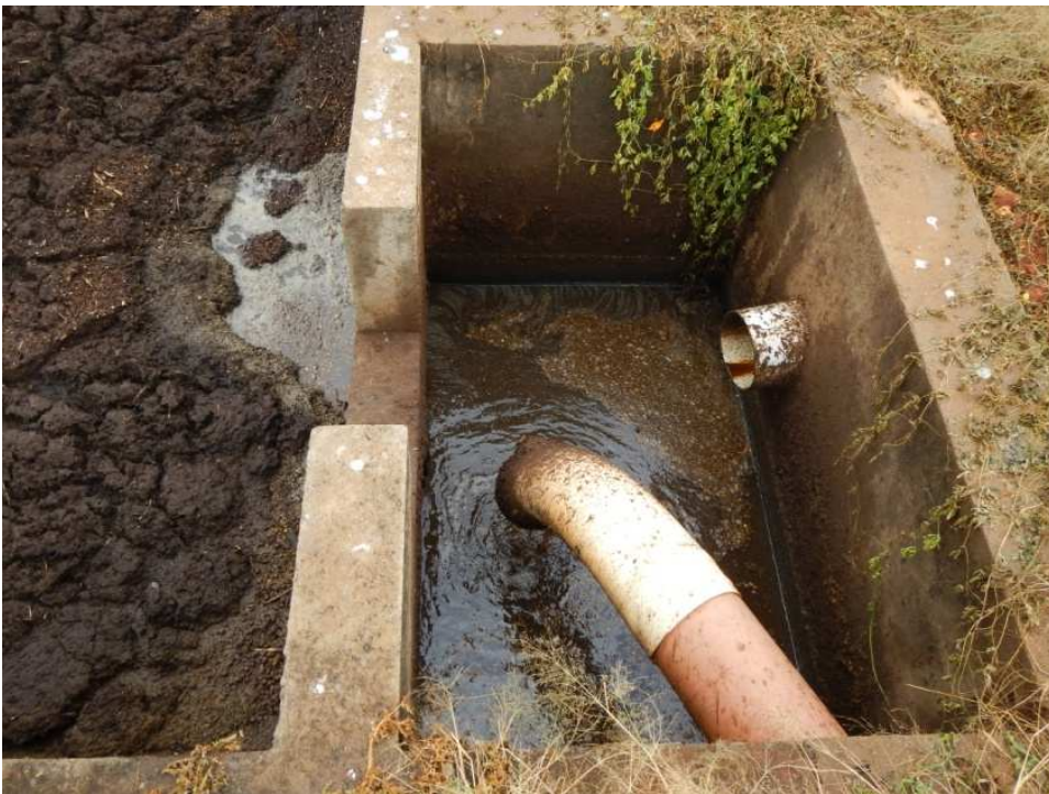
FIGURA 3.7 - Caixa de entrada para a diluição do esterco. Fonte: Elaborado pelo autor.
