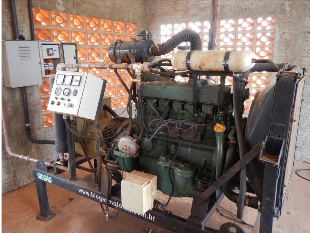
FIGURA 3.14 - Conjunto motogerador. Fonte: Elaborado pelo autor.
