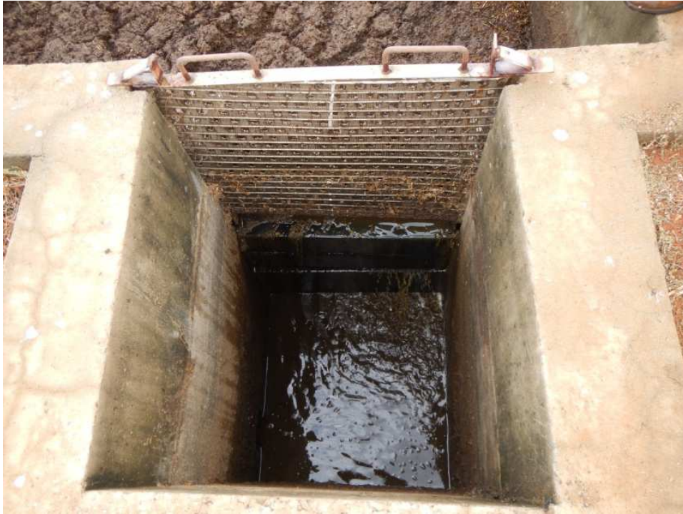
FIGURA 3.8 - Caixa de entrada do biodigestor, após a diluição dos dejetos. Fonte: Elaborado pelo autor.
