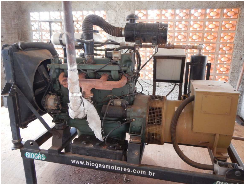
FIGURA 3.15 - Conjunto motogerador. Fonte: Elaborado pelo autor.
