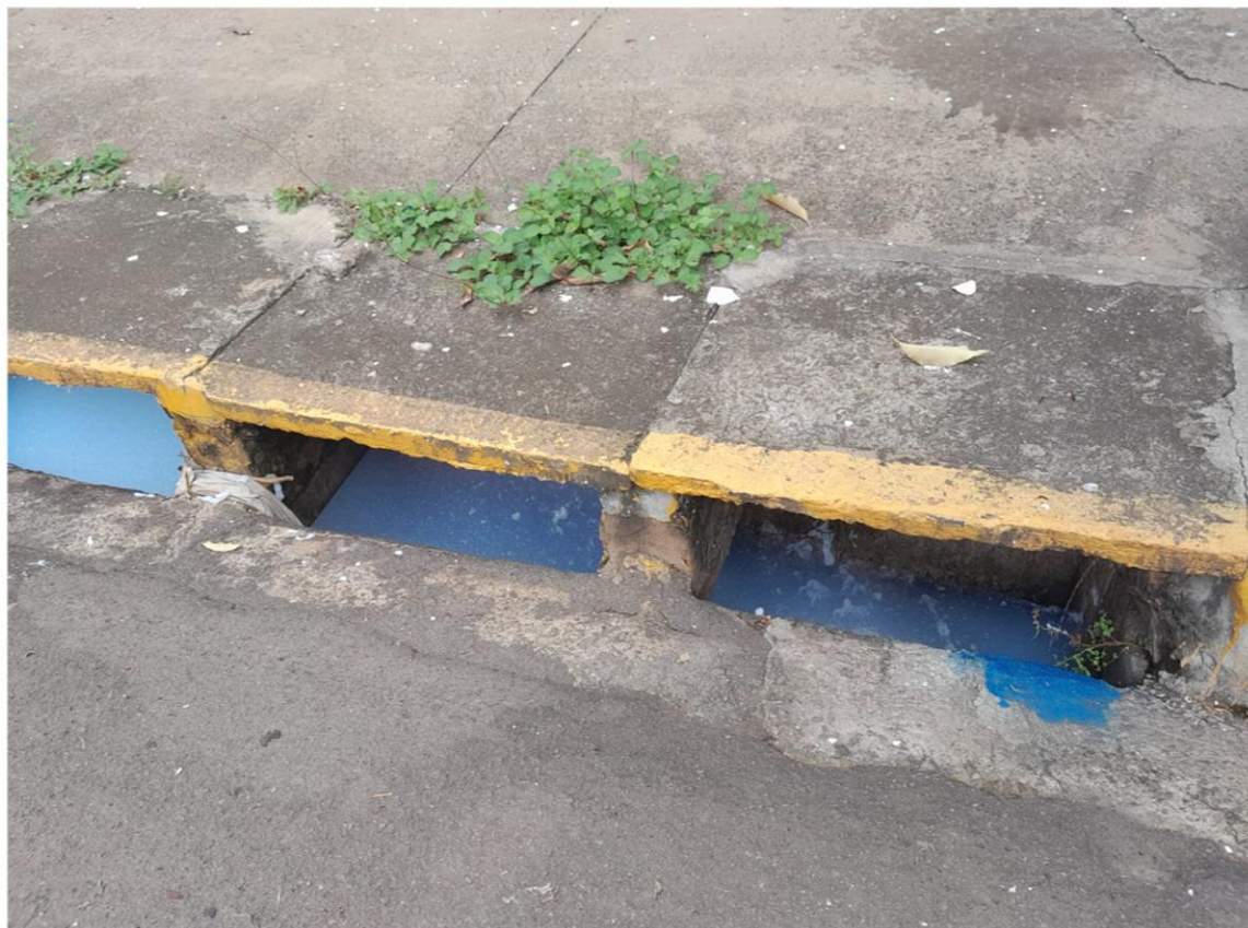
Foto 3: - Boca de lobo na Rua Manoel Eugênio - Jardim Bongiovani
