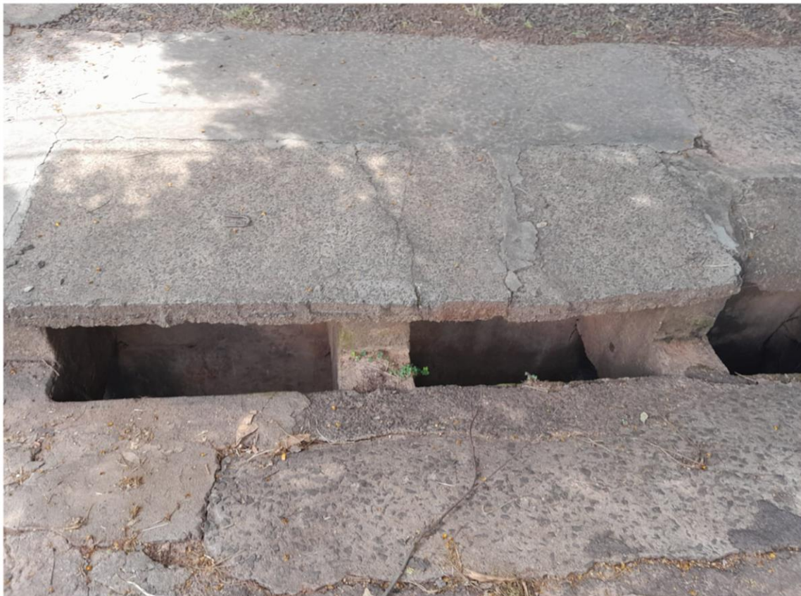
Foto 4: Boca de lobo na Rua Manoel Eugênio - Jardim Bongiovani
