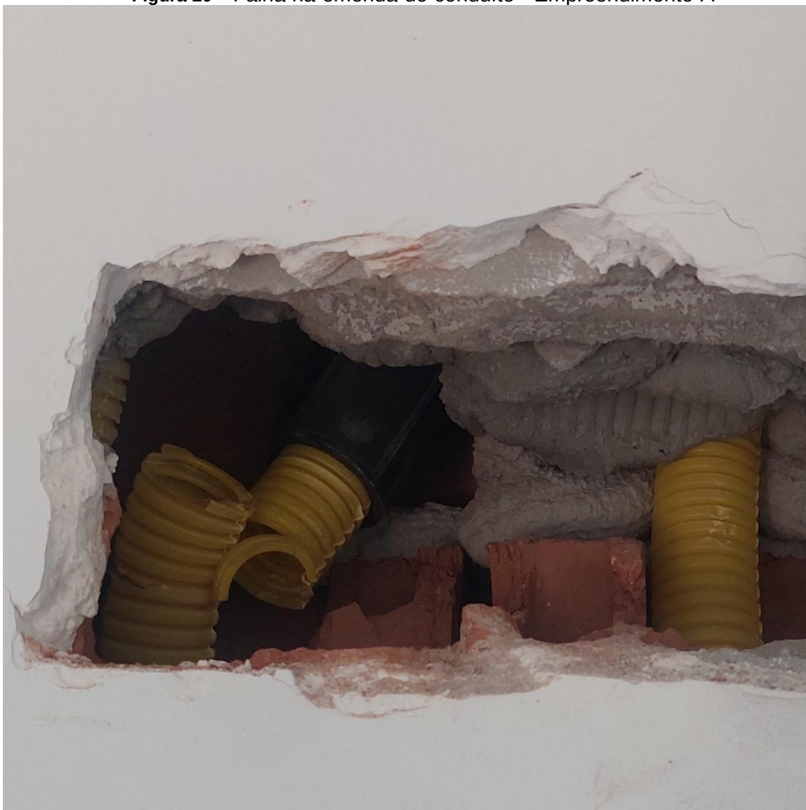
Figura 20 – Falha na emenda do conduíte - Empreendimento A
