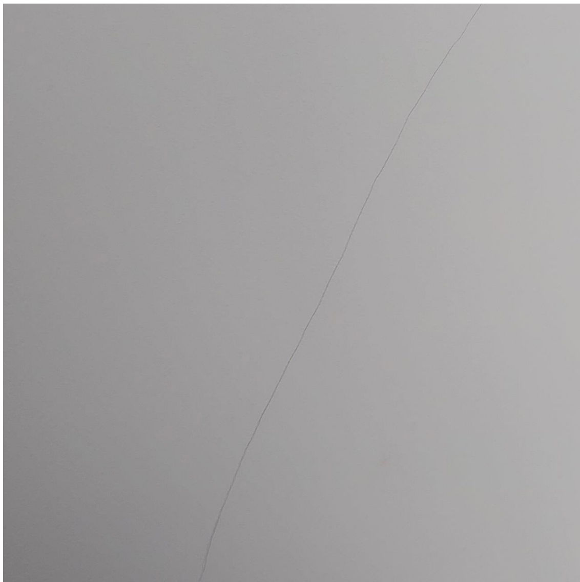
Figura 15 – Fissura revestimento de gesso - Empreendimento A
