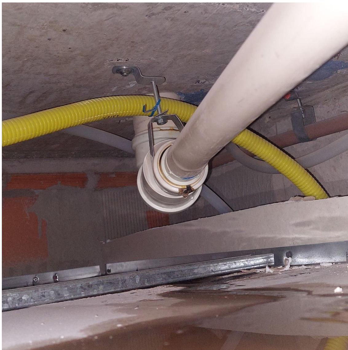
Figura 28 – Vazamento ocasionado por conexão danificada - Empreendimento B
