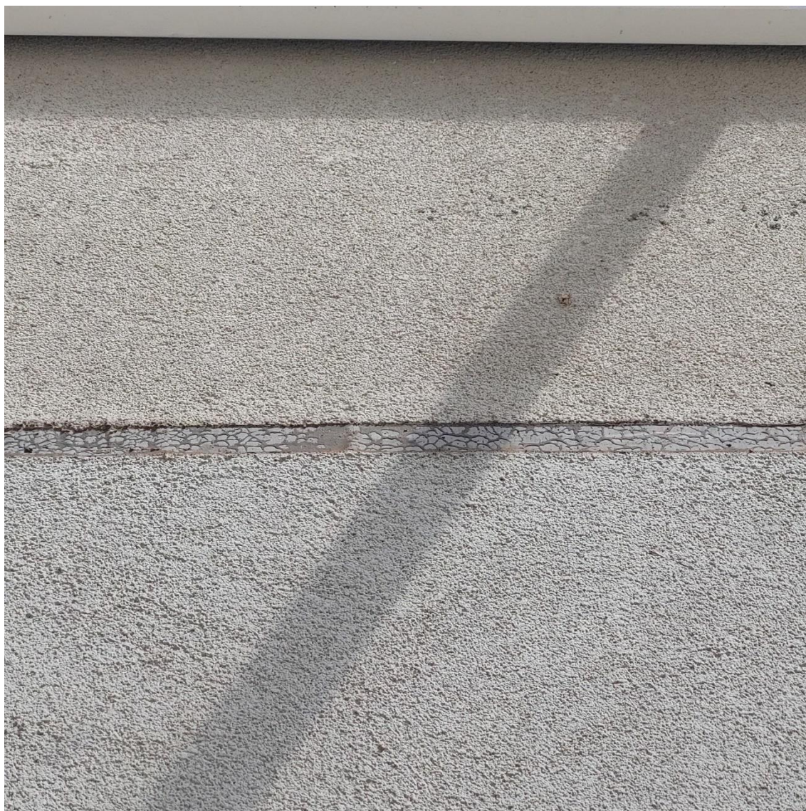
Figura 11 – Fissura junta de movimentação - Empreendimento A
