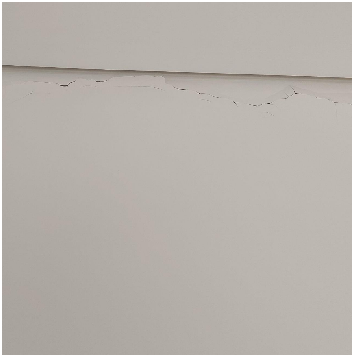
Figura 31 – Revestimento danificado devido falha no encunhamento - Empreendimento B
