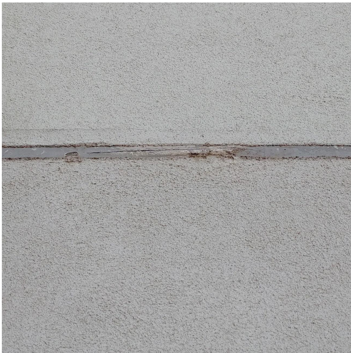
Figura 10 – Fissura junta de movimentação - Empreendimento A
