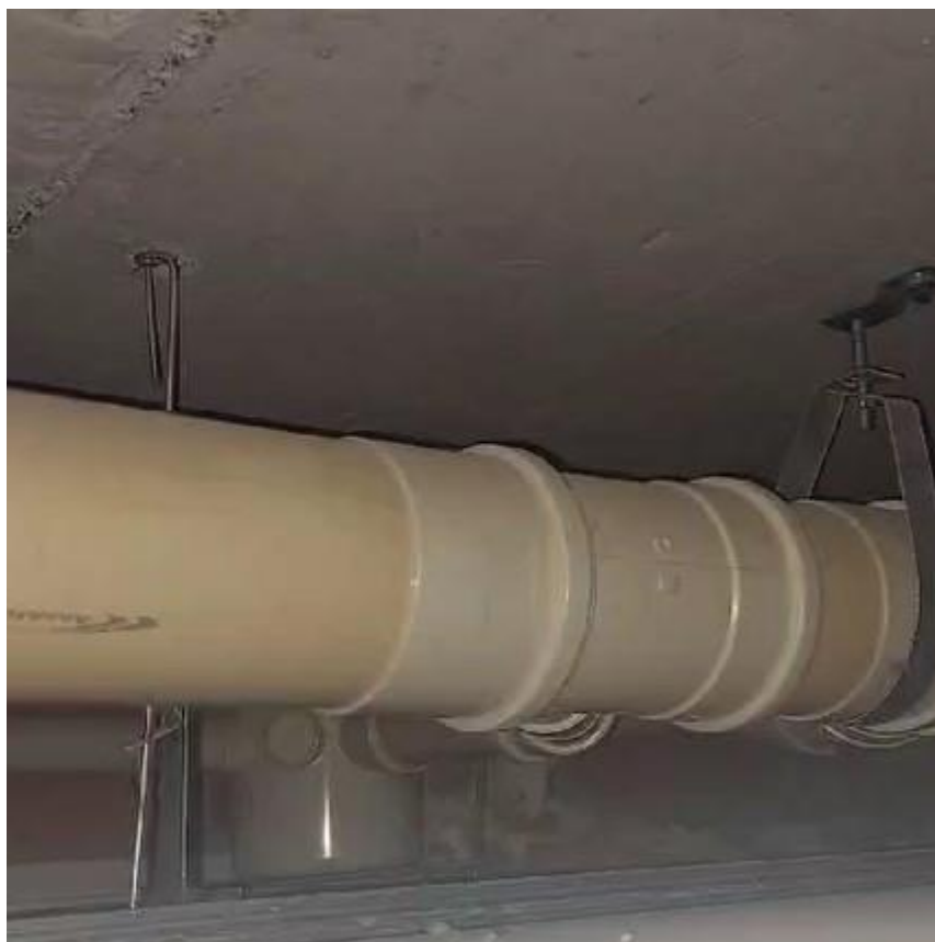
Figura 25 – Tubulação fixada em laje e apoiada em suporte em unidade autônoma - Empreendimento B
