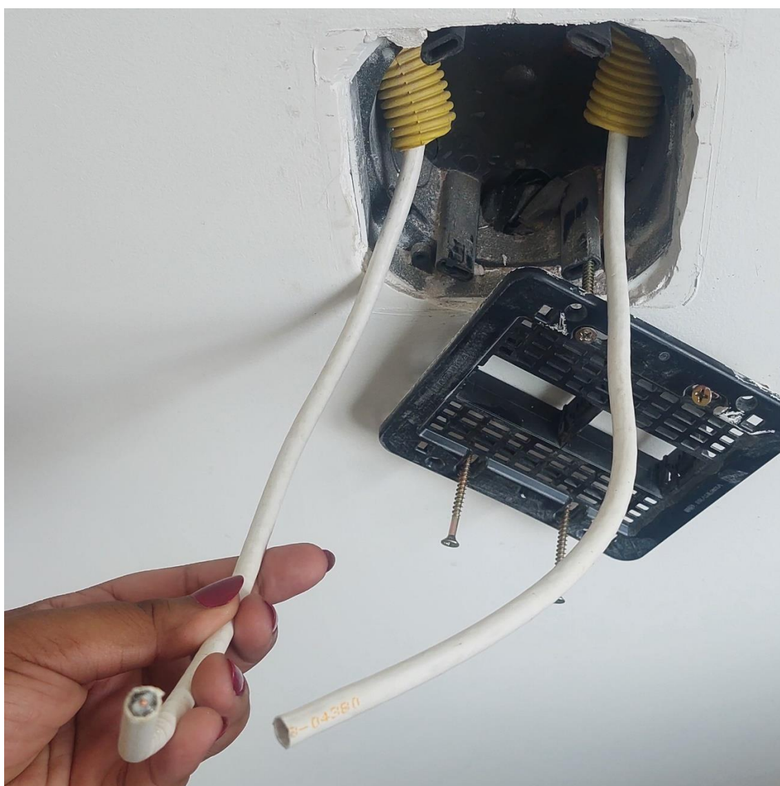
Figura 21 – Falha de emenda dos cabos coaxiais a - Empreendimento B
