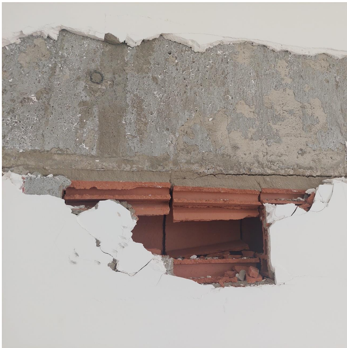
Figura 32 – Falha no encuamento - Empreendimento B
