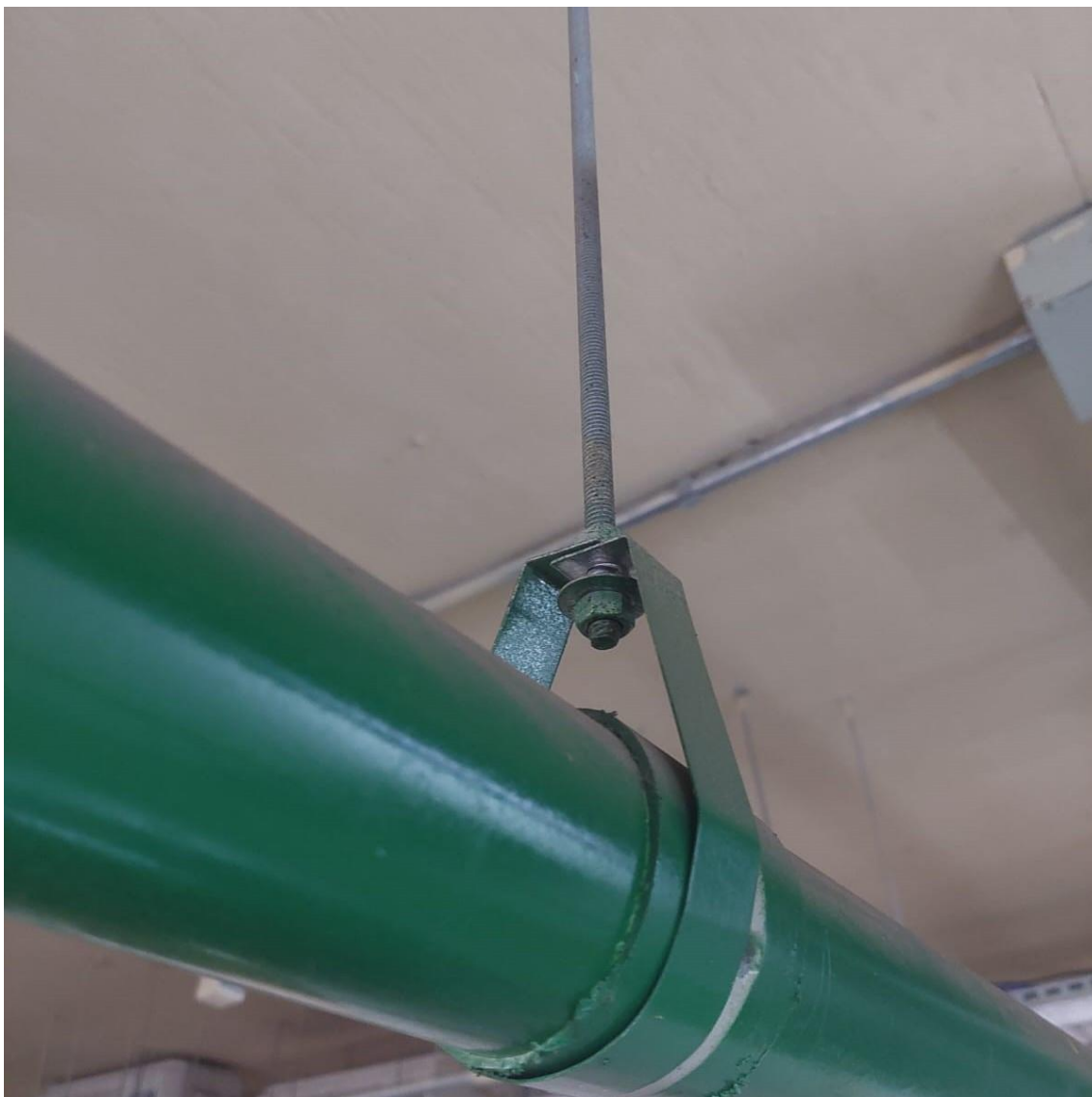
Figura 24 – Tubulação fixada em laje e apoiada em suporte em área externa - Empreendimento A
