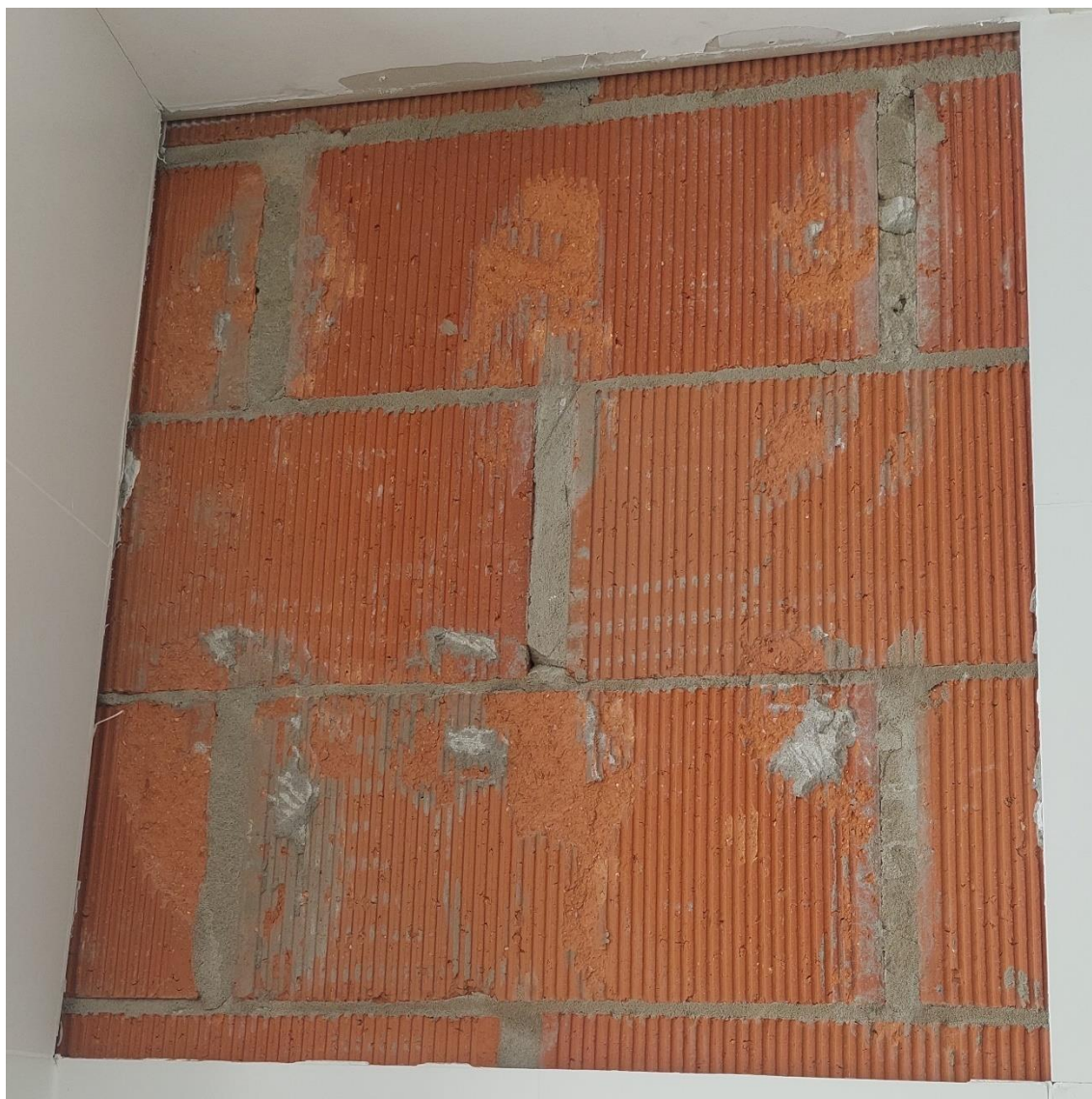
Figura 18 – Falha assentamento de revestimento cerâmico - Empreendimento B
