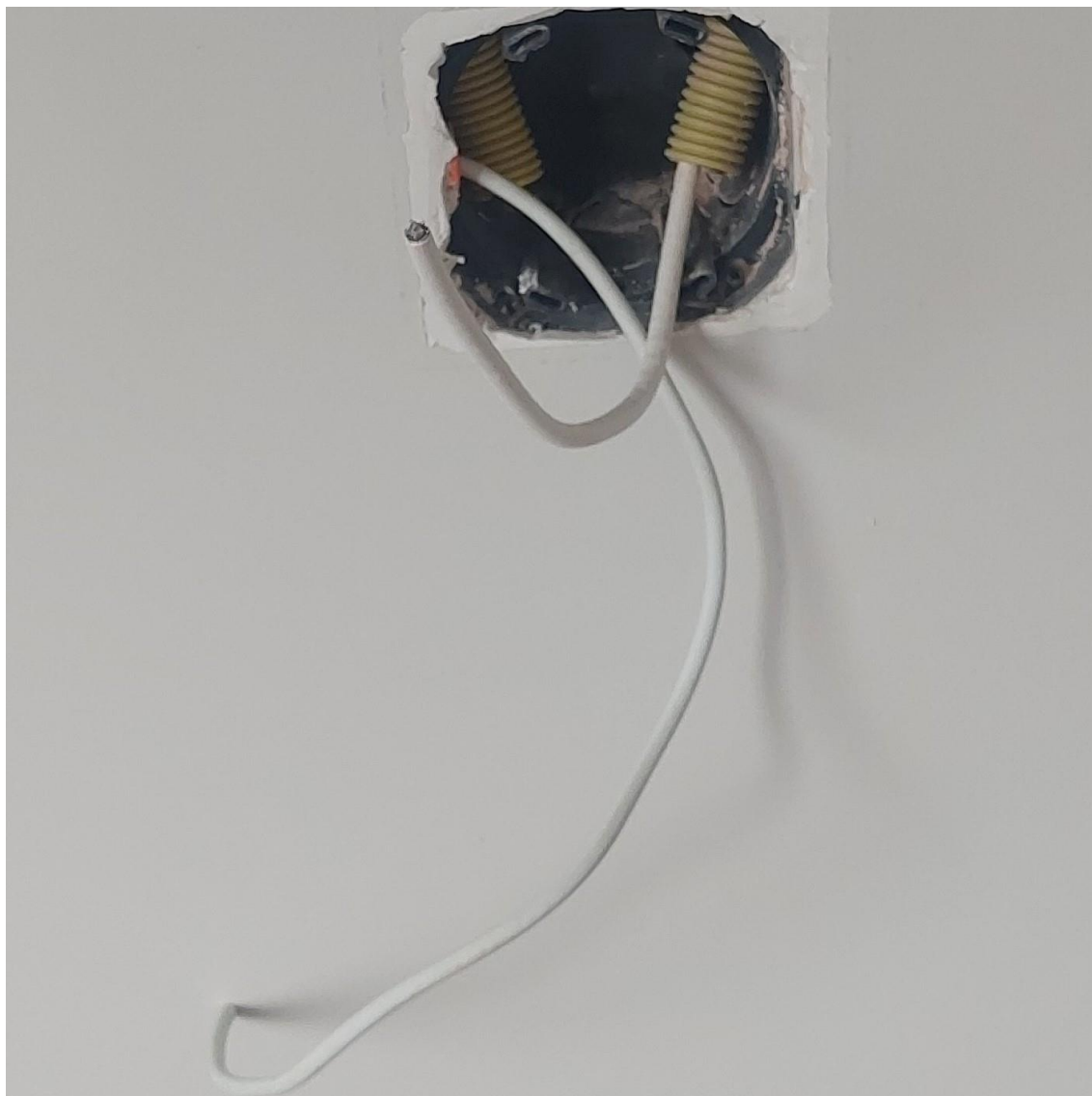
Figura 22 – Falha de emenda dos cabos coaxiais b - Empreendimento B
