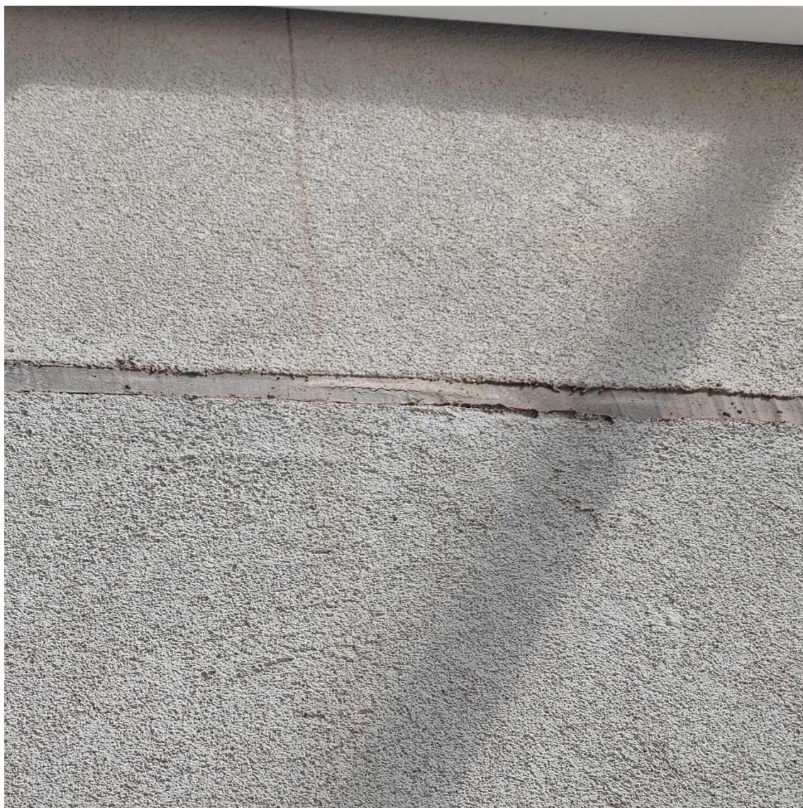
Figura 12 – Falha de acabamento em junta de movimentação - Empreendimento A
