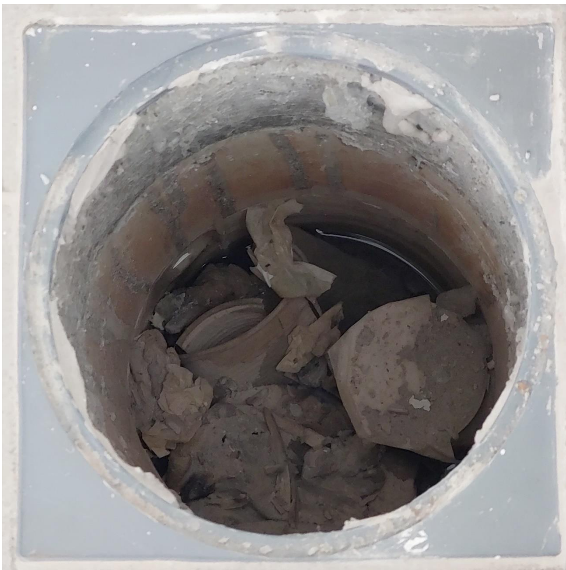
Figura 26 – Ralo obstruído com entulho de obra - Empreendimento A
