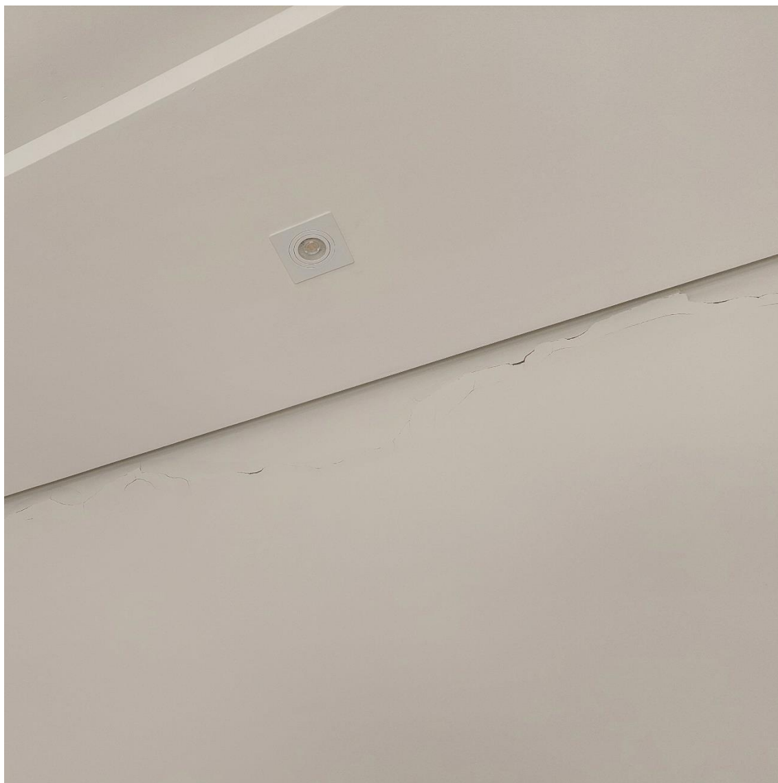
Figura 30 – Revestimento danificado devido falha no encunhamento - Empreendimento B
