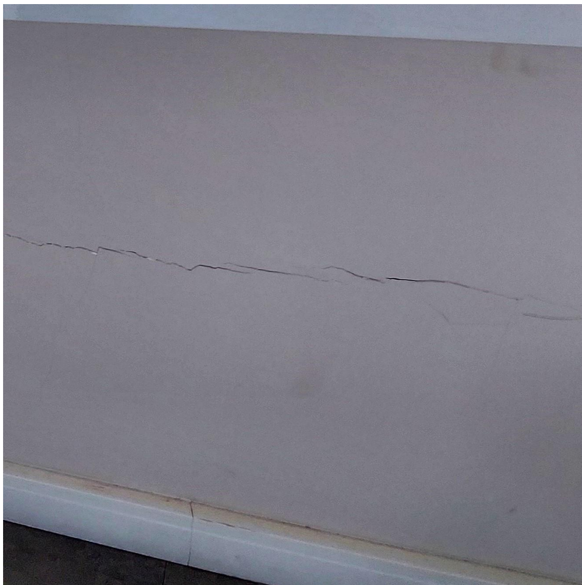
Figura 16 – Trinca revestimento - Empreendimento A
