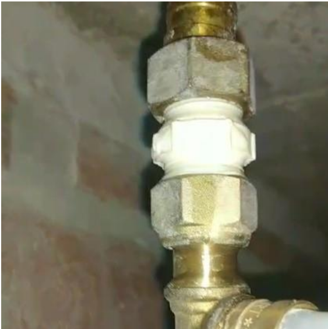
Figura 29 – Conexão incorreta em instalação PEX - Empreendimento B
