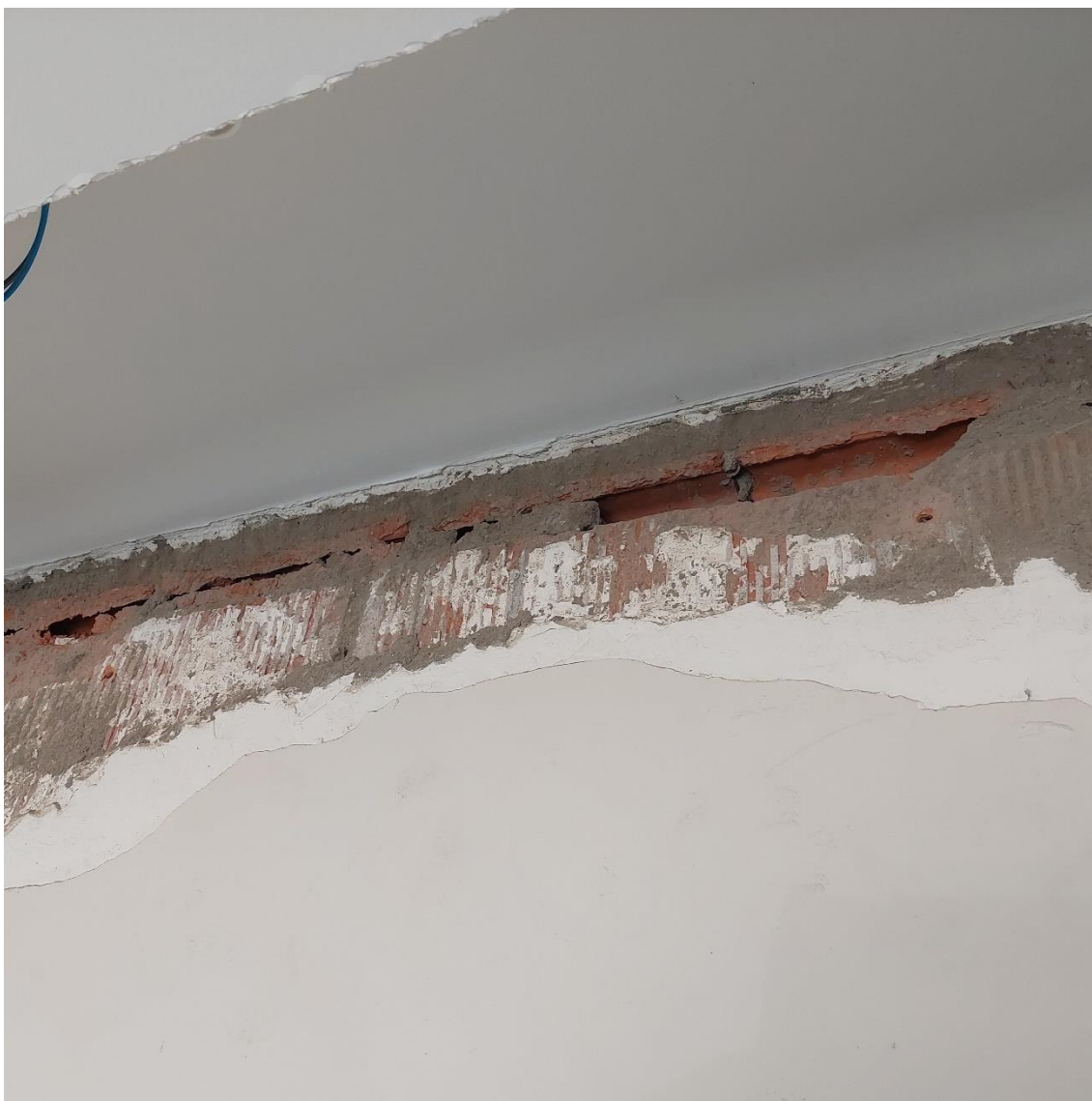
Figura 33 – Blocos danificados devido falha no encunhamento - Empreendimento B
