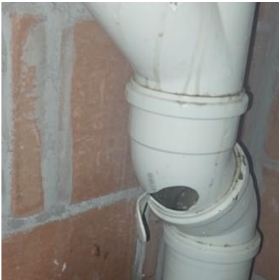
Figura 27 – Tubulação hidráulica danificada - Empreendimento B
