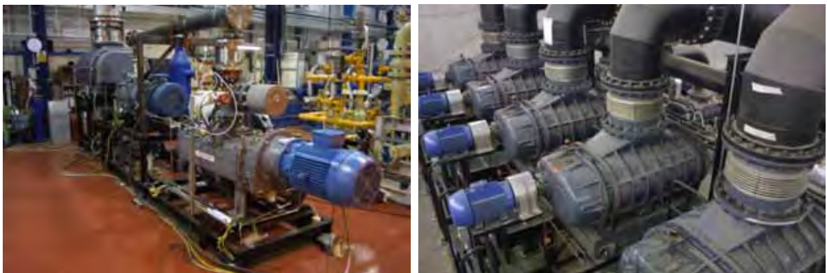
Figura 32: Instalação das bombas secas em indústrias de aço (Ewards, 2012a).
