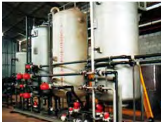
Figura 7: Tanques de troca iônica, desmineralização (ENGENHARIA DE PROCESSO,2012).
