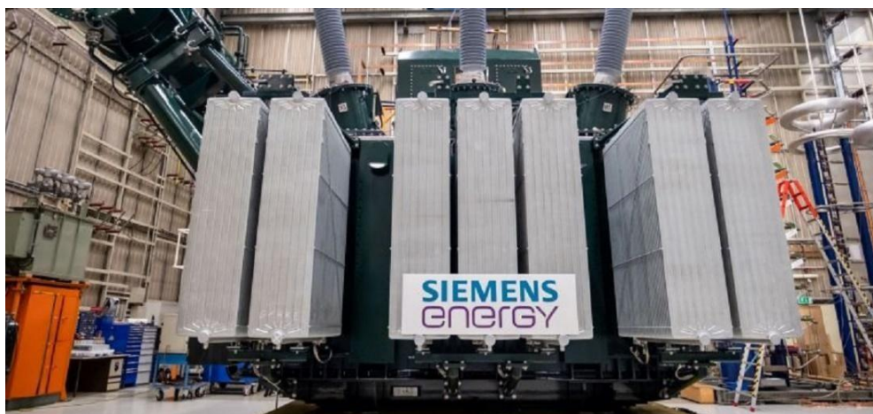
Figura 1 – Transformador de Potência 240 kV
