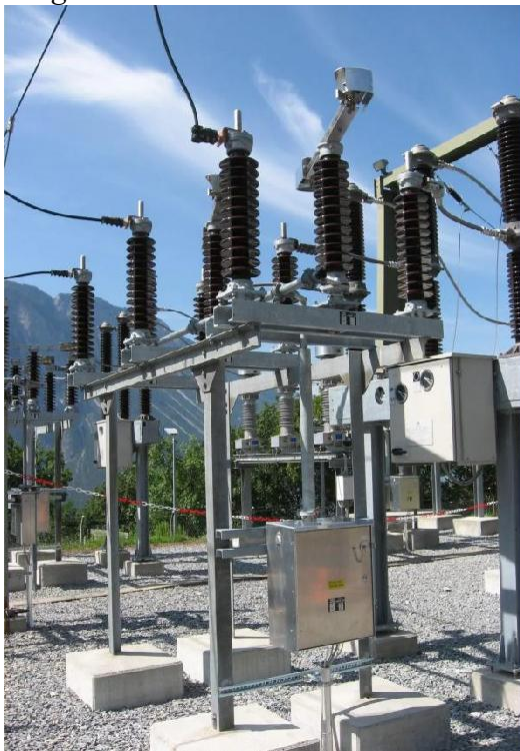
Figura 3 – Chave Seccionadora 69kV
