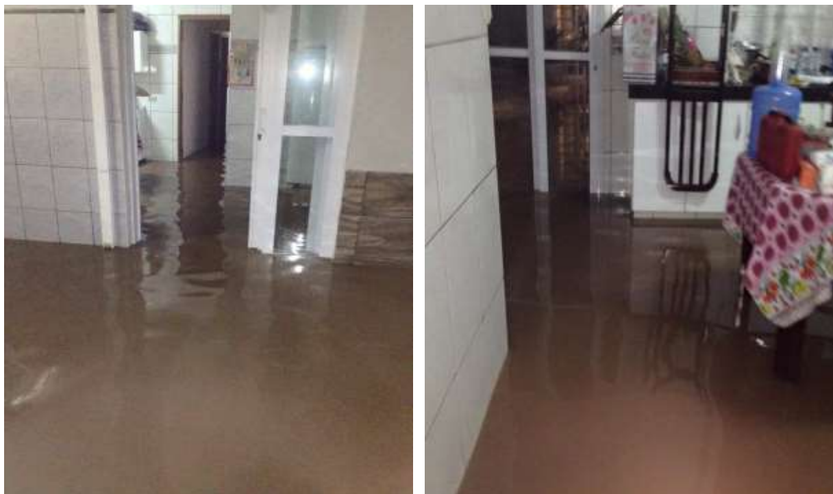
Figura 32. Interior da casa de Adriana após a inundação de 26 de dezembro de 2015
