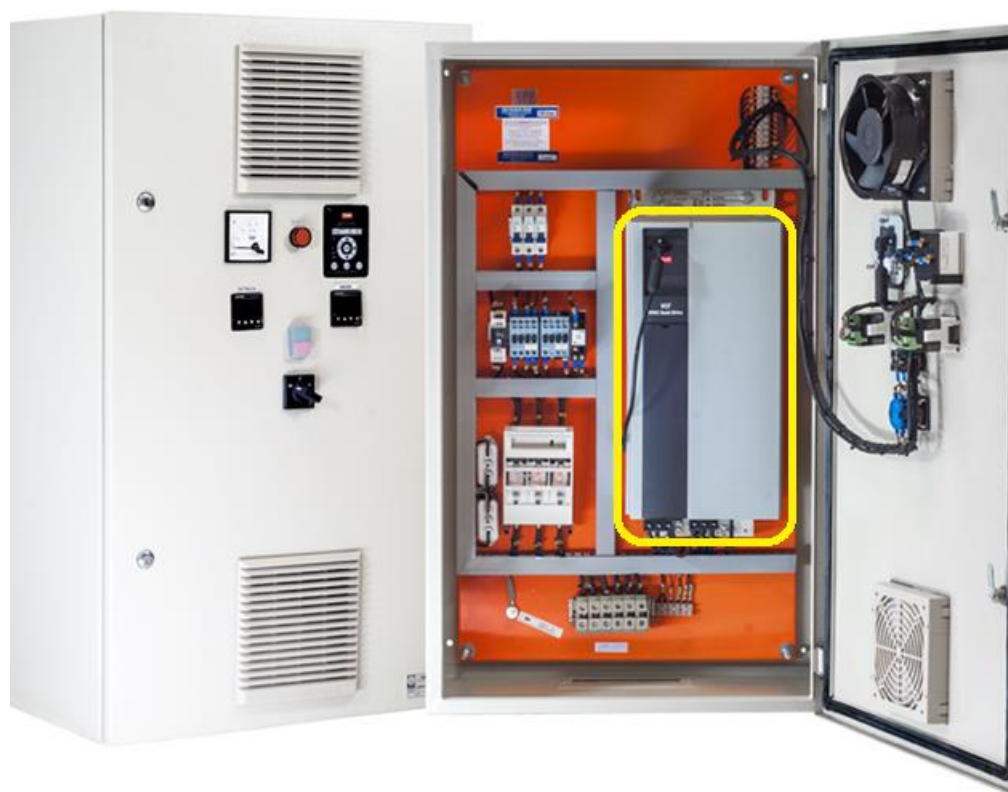
Figura 123 – Painel de média tensão com destaque para seu inversor de frequência
