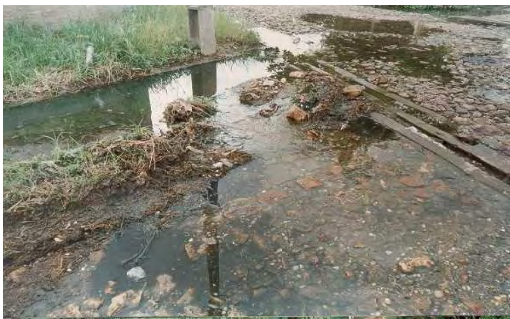
Figura 32: Esgoto bruto escoando a céu aberto no bairro Pedra Mole, Zona Leste. Fonte: Prof. Carlos Gomes Correia Lima (2004).
