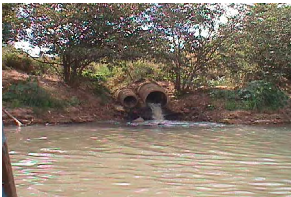
Figura 30: Galeria pluvial - lançamento de esgoto bruto no rio Poti. Fonte: Prof. Carlos Gomes Correia Lima (2004).
