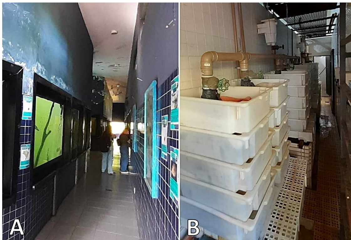
Figura 15. Aquário do zoológico municipal de Ribeirão-Preto/SP, 2022. A. Vista da área de visitação do aquário. B. Vista da parte interna onde ficam alojados os filtros d’água. Fonte: Felipe Abrahao.
