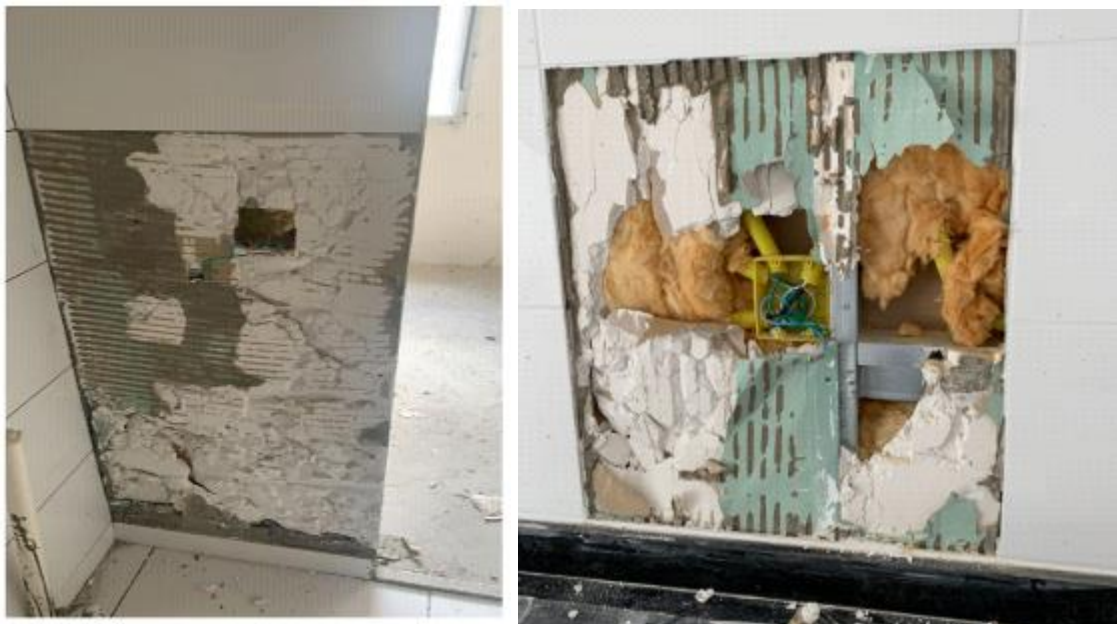
Figura 43 – Necessidade de retrabalho após a instalação do Drywall
