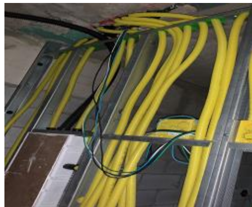
Figura 42 - Mangueiras deslocadas nas áreas onde é executado o forro.
