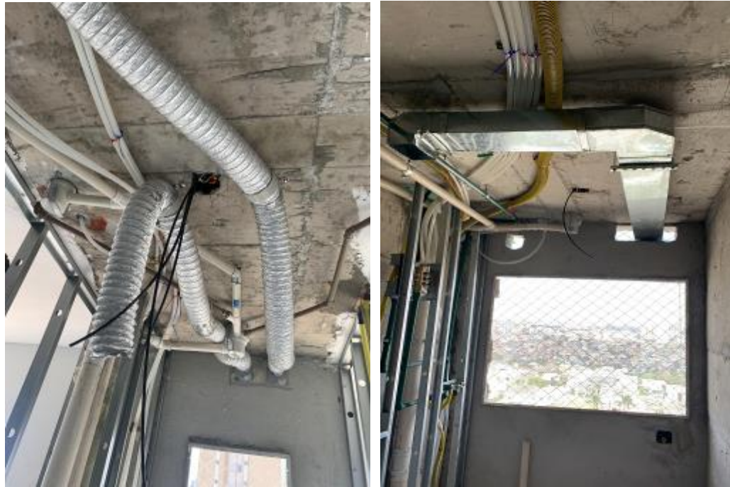
Figura 33 - Dutos flexíveis do banheiro.
