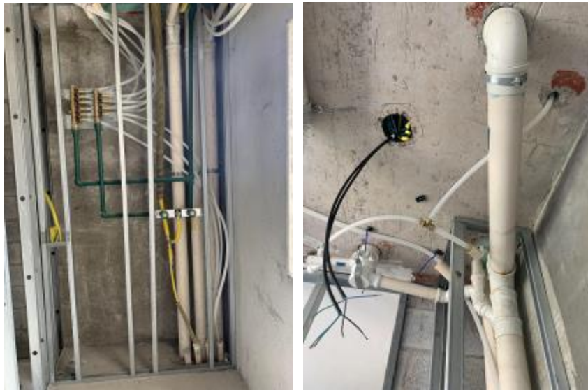
Figura 31 - Distribuição de água fria, água quente e gás, manifold instalado na área de serviço; distribuição horizontal de esgoto (direita).
