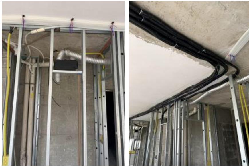
Figura 32 - Caixa polar instalada para passagem de infra de ar condicionado (esquerda); infraestrutura de ar condicionado (direita).
