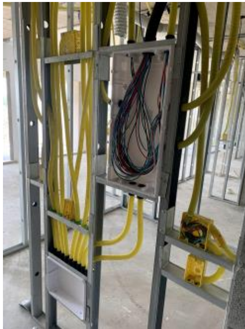
Figura 29 - Quadro de energia e quadro de sistemas da unidade.
