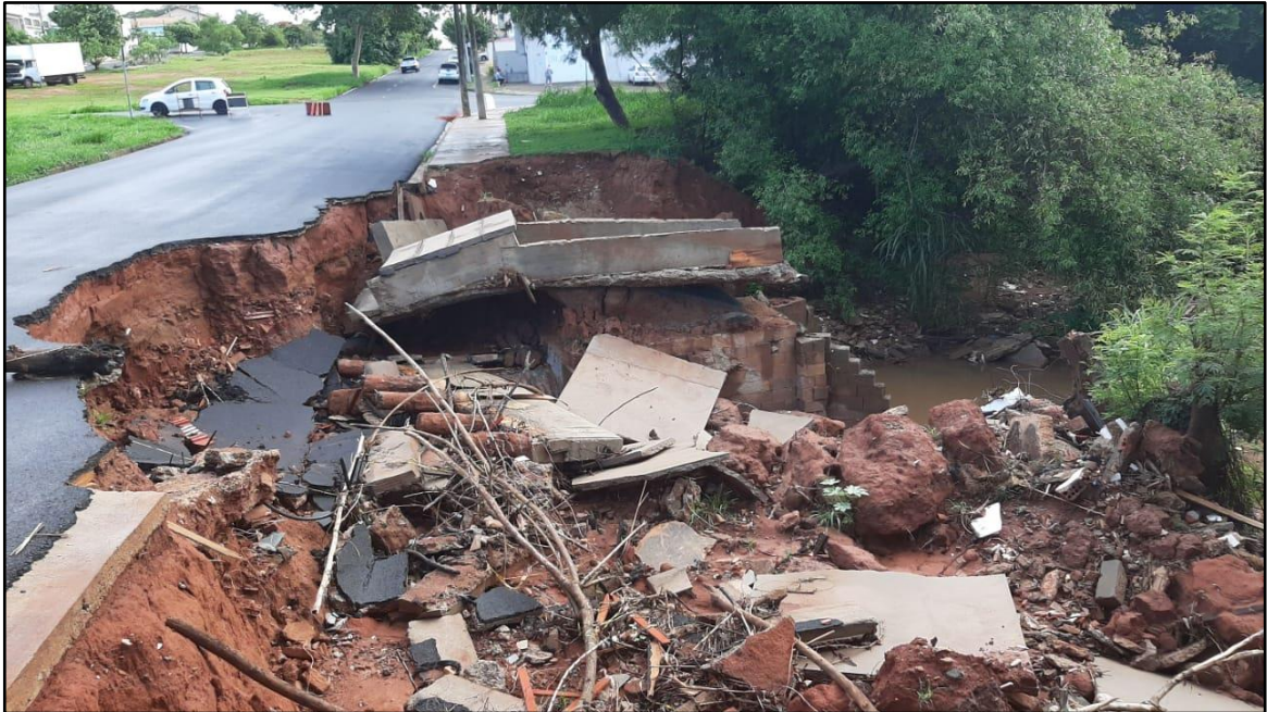
Figura 24 – Erosão fluvial em trecho urbano do Córrego dos Macacos.
