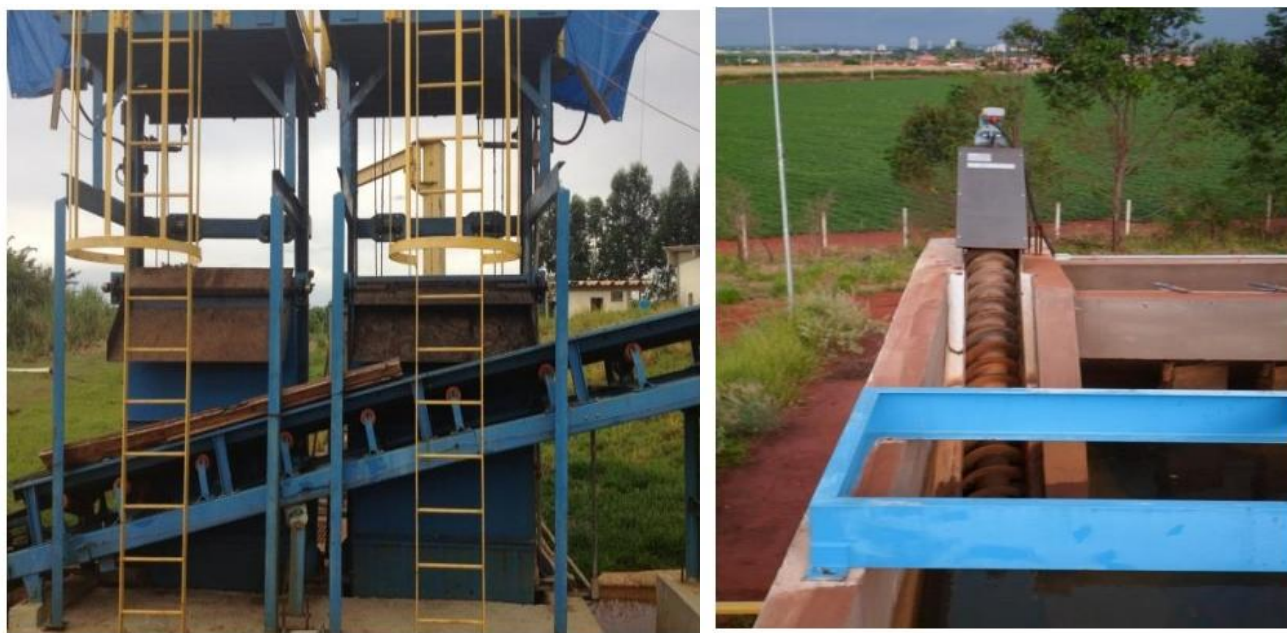
Figuras 43 e 44 - Tratamento preliminar – gradeamento (a esquerda) e Caixa de areia (a direita)
