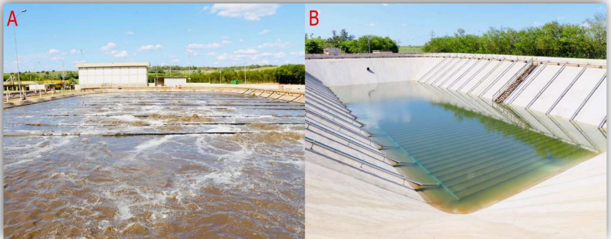
Figura 9 – Vista do reator (ou tanque de aeração) na ETE – Pitico.
