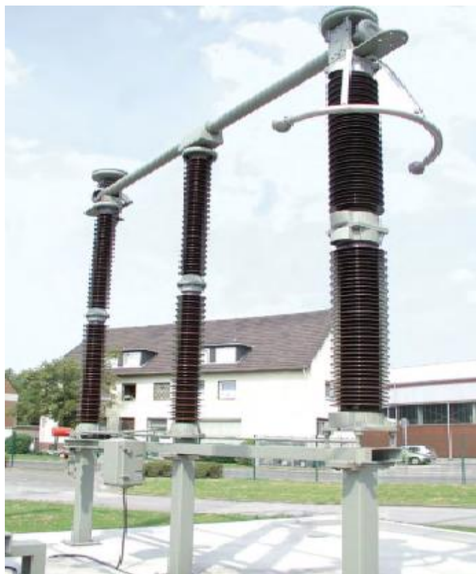
Figura 5. Seccionadora 245 kV dupla lateral, com para-raios integrados.
