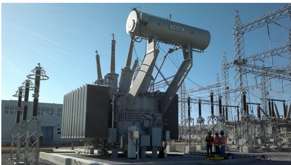
Figura 2. Transformador de Potência de Alta Tensão.
