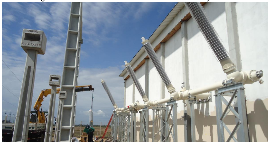
Figura 21. Para-raios e seccionadores AIS nos bays da GIS
