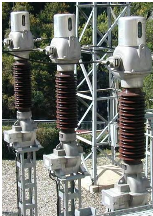
Figura 8. Transformadores de Instrumento 145 kV.
