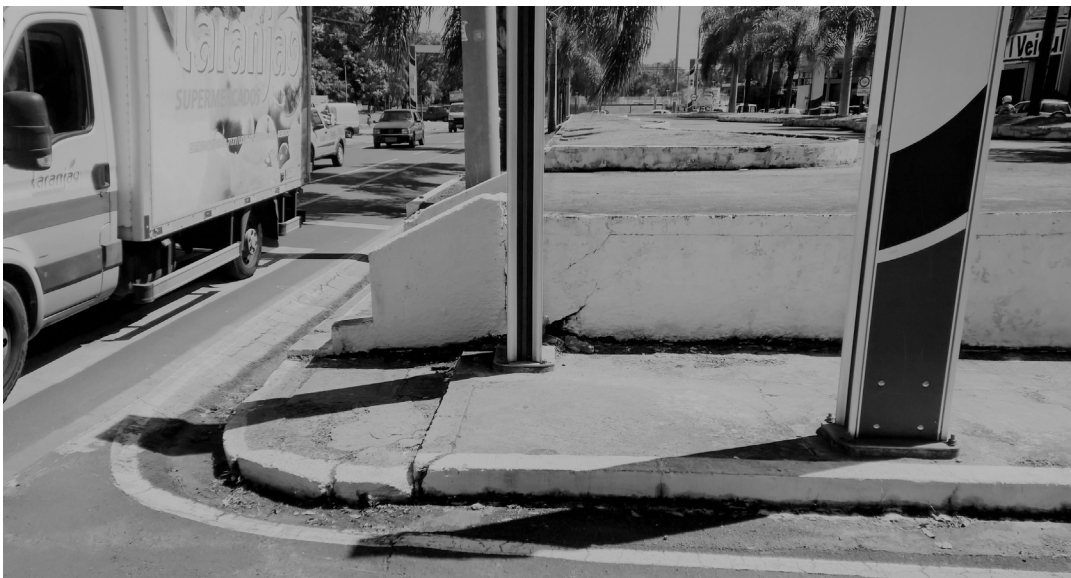
figura 40 - Calçamento irregular nas travessias do rio Preto.
