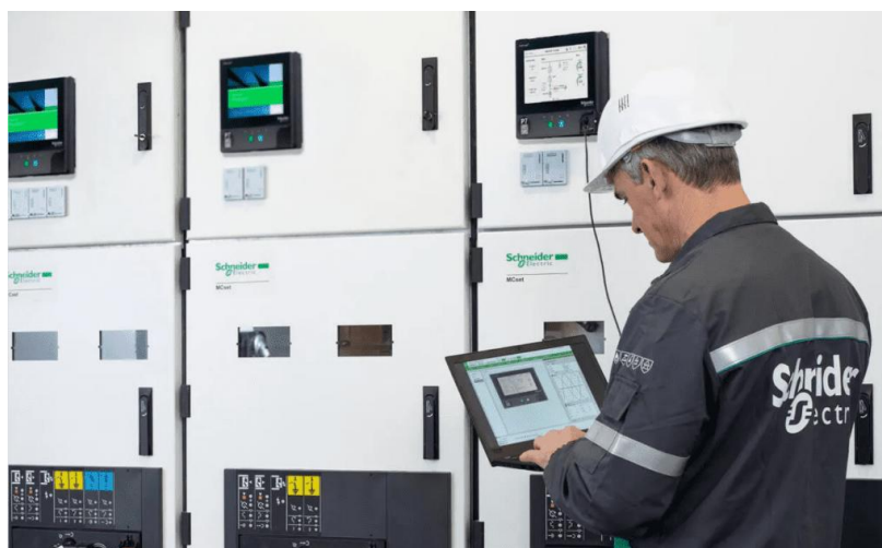
Figura 1 - Painel elétrico com multimedidor
